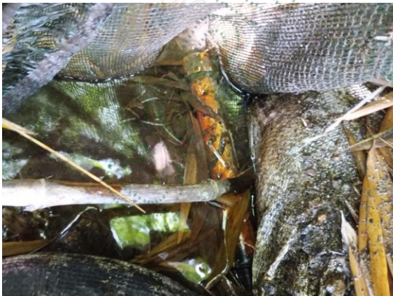
Obra de control de caudal
