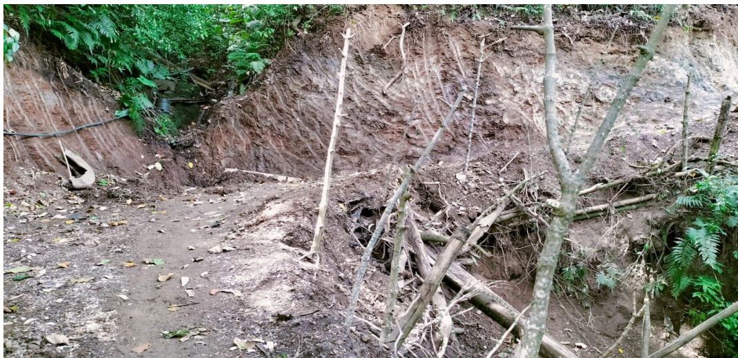
Imagen 1: Fuente hídrica número 1, ampliación del camino donde se observa remoción de material con maquinaria y depósito de tierra y material residuos vegetales sobre la fuente.
