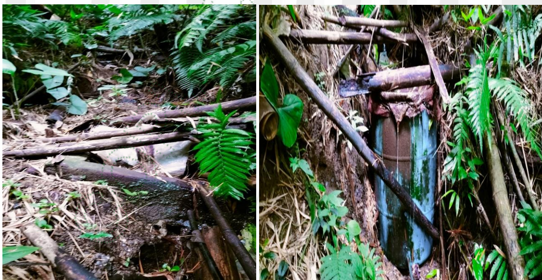
Imágenes 1 y 2. Punto de captación y tanque de almacenamiento instalados en la fuente.
