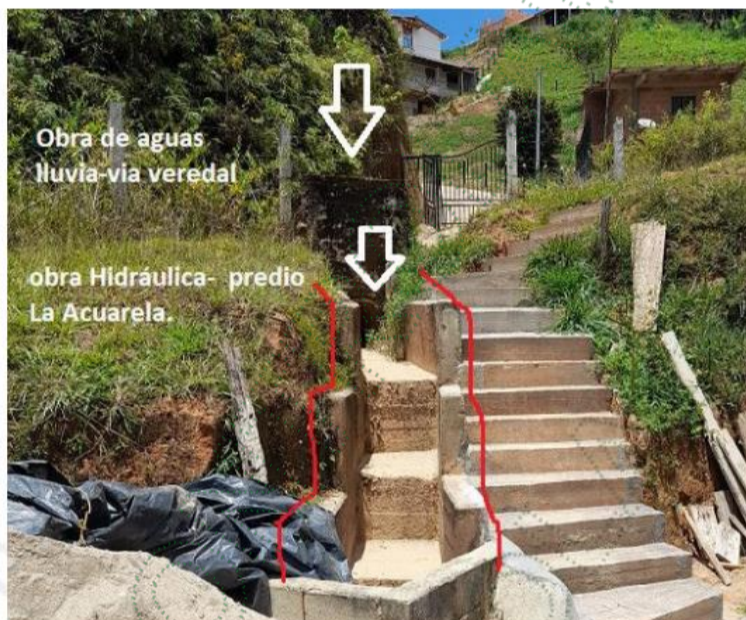
Fotografía 1. Donde se evidencia la infraestructura para el manejo de las aguas lluvias al interior del predio La Acuarela.
