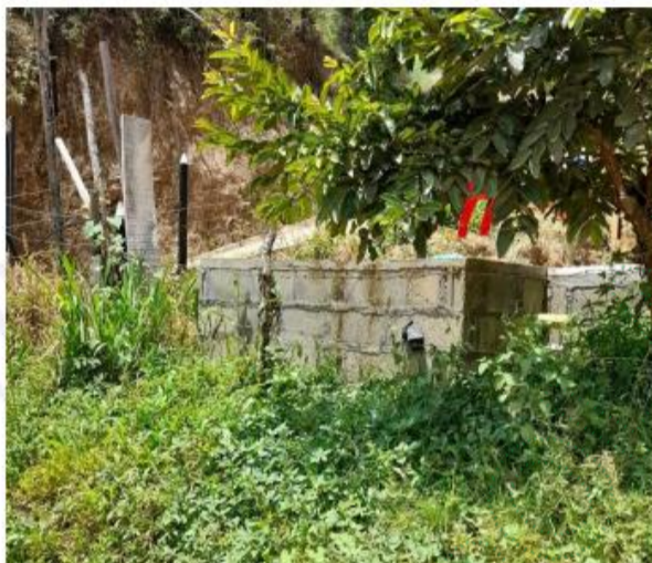
Fotografía 4. Sistema de tratamiento de aguas construido hace 6 meses, en la propiedad de la señora Luz Dénny Villa
