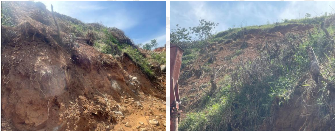
Figura 2. Estado del talud por actividades de movimiento de tierras. Fuente: Cornare 2026
