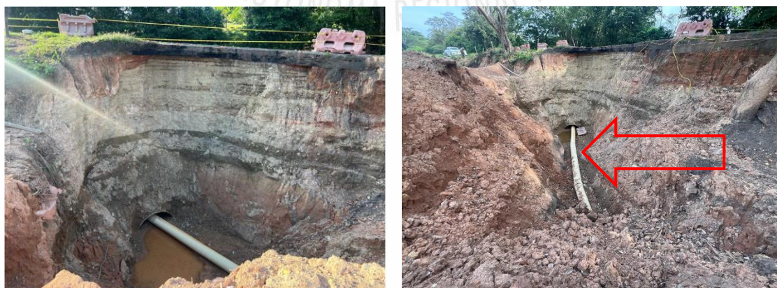
Foto 1 y 2. Encole de obra hidráulica de la Autopista Medellín Bogotá PR 119+600, tubería sedimentada y jarillón construido. Fuente: Cornare 2024.
