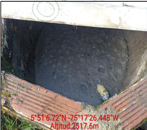
Trampa de grasas requiere mantenimiento inmediato
