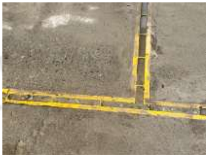
Foto 2. Estado de los cárcamos perimetrales de la EDS El Mármol. Fuente: Cornare 2024
