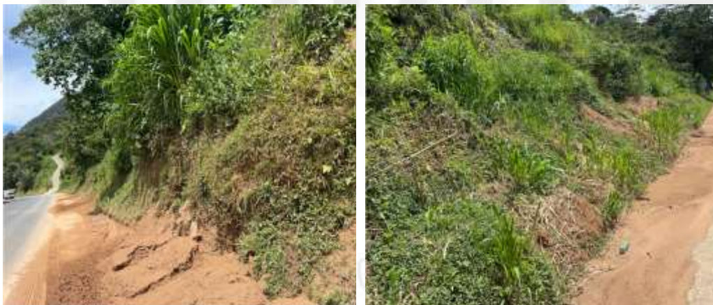
Fotos 18 y 19. Depósito de sedimentos sobre la Autopista Medellín Bogotá entre el PR 20+000 y PR 22+000. Fuente Cornare 2024.
