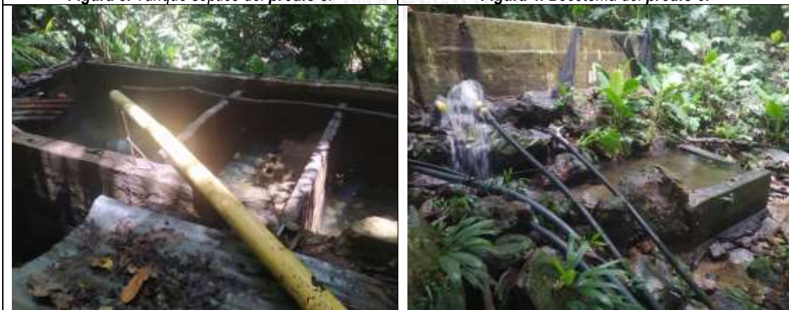
Figura 5 y 6. Tanque de almacenamiento del predio 6.
