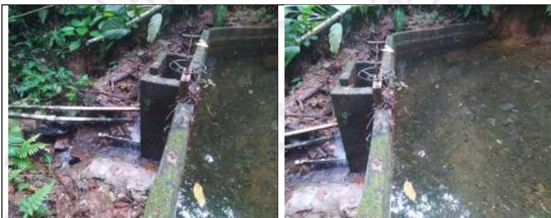
Figuras 1 y 2. Obra de captación en la Q. Catural de los predios 1 al 5.
