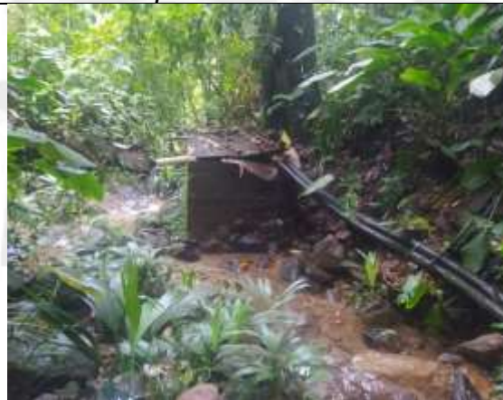
Figura 8. Tanque de abastecimiento y desarenador del predio 7.
