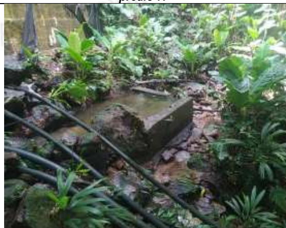
Figura 10. Obra de captación del predio 8.
