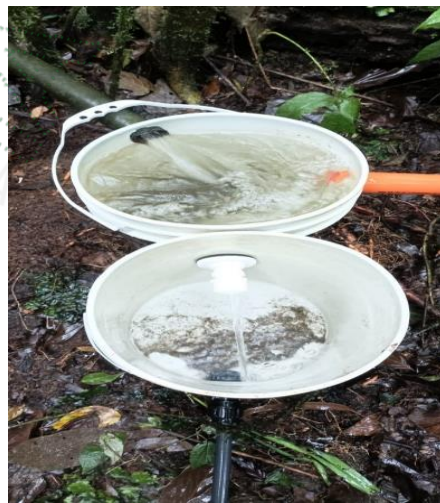
Sistema de control de caudal que cumple con los diseños entregados por Cornare, tapón perforado con broca 5/16 que garantiza el caudal otorgado, excedente a fuente por tubería de 2 pulgadas
