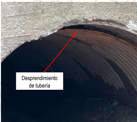
Foto 11. Desprendimiento de tubería metálica en el descole de la obra hidráulica. Fuente: Cornare 2024.
