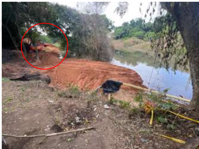
Foto 1. Retroexcavadoras y depósito de suelo sobre la quebrada “Cañada Inés”. Fuente Cornare 2024
