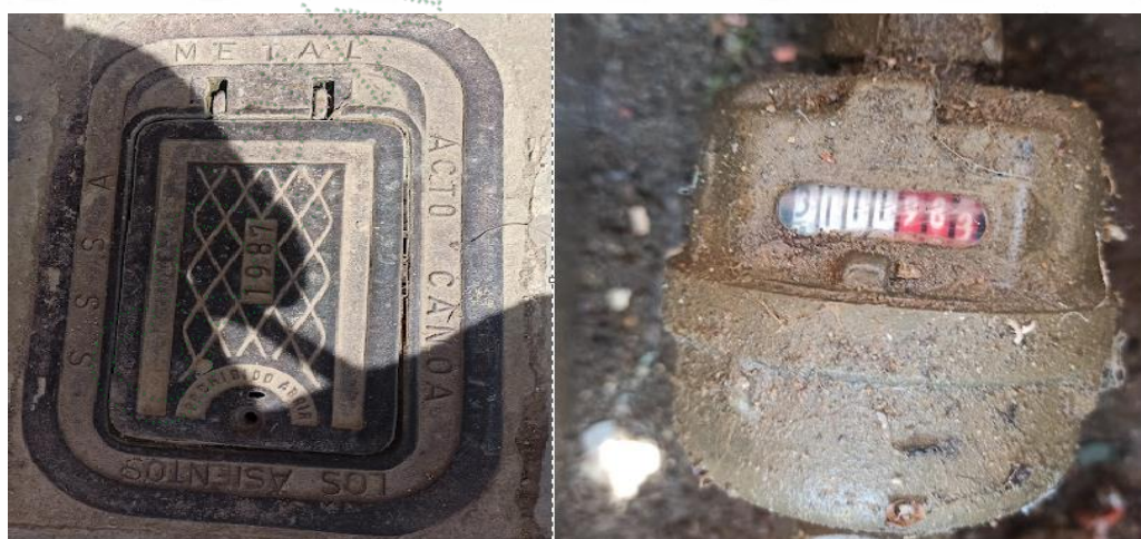
Imagen 4. Tapa del contador y micromedidor
