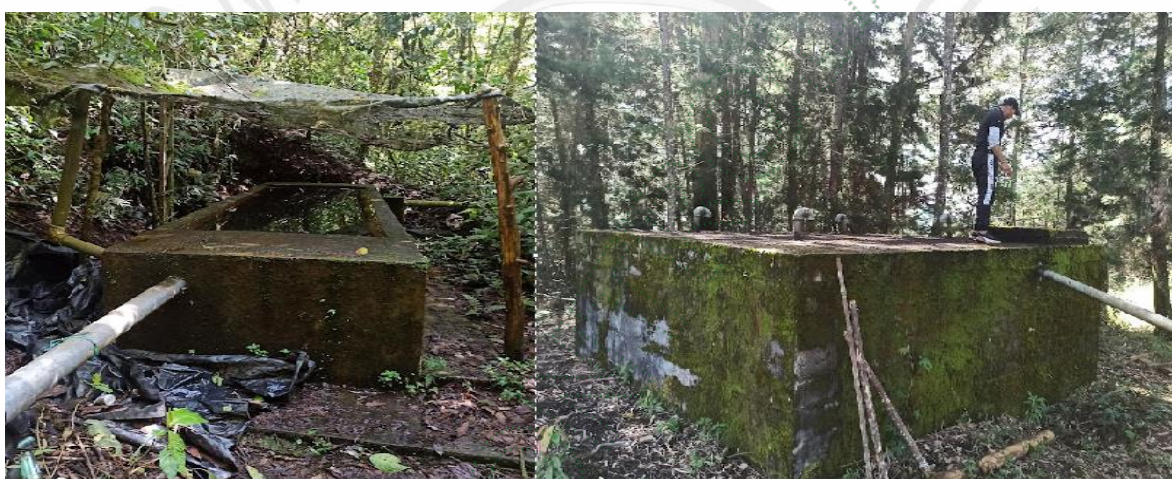
Imagen 3 Desarenador y tanque de almacenamiento.
