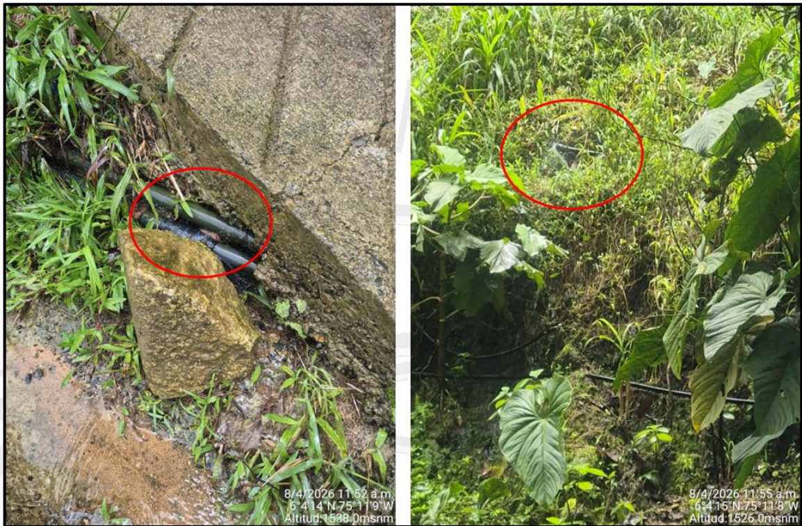
Imagen 3: Mangueras con fugas de agua. Fuente: Cornare
