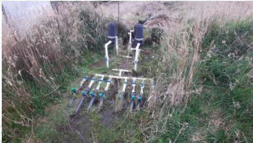
Sistema de riego por goteo con válvulas de control en el predio
