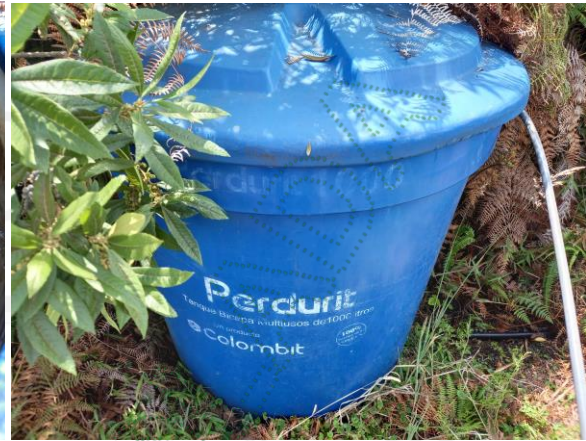
Imagen # 2 Tanque de almacenamiento con tubería de rebose
