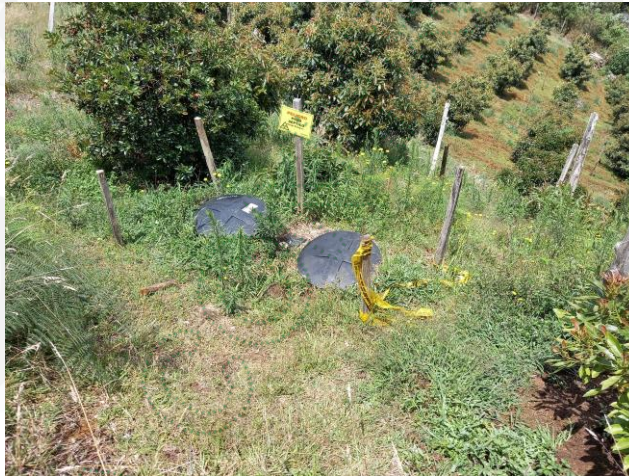
Imagen # 3 Sistema de tratamiento de agua residual
