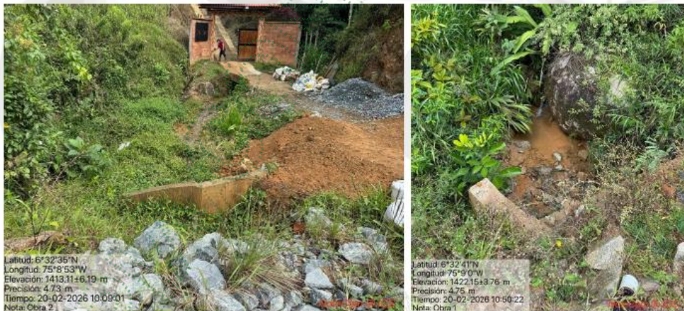
Imágenes 6 y 7. Ocupaciones de cauce.
