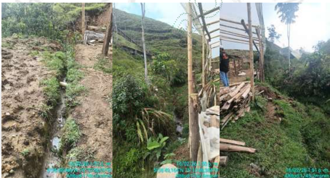
Drenaje que va a la fuente y construcción en el cauce a menos de 1 metro de la fuente.
