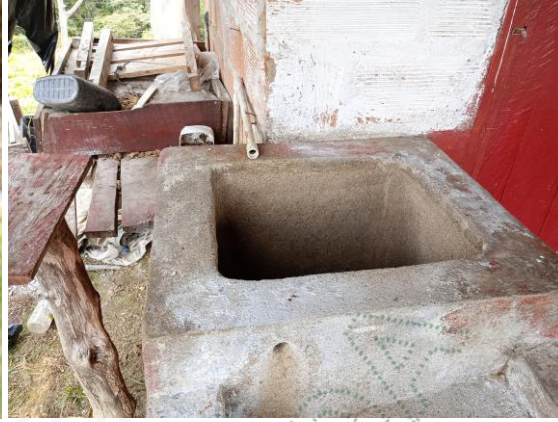
Tanque de almacenamiento fuera de servicio
