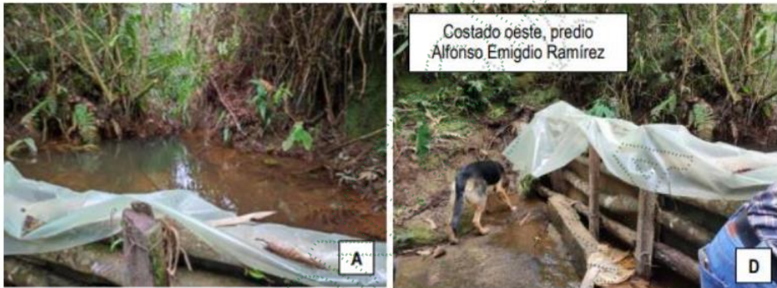
Figura 1. El antes de los trinchos sobre la fuente El Castillo
