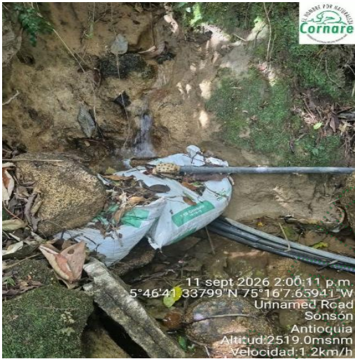
Imagen 2. Punto de captación
