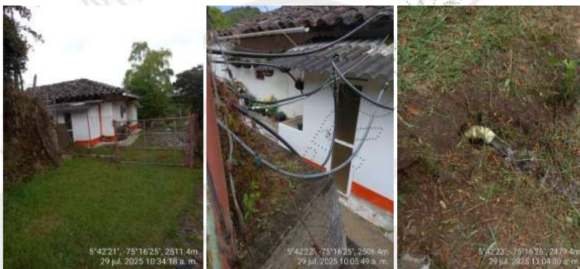
Imagen 4. Evidencia del uso inadecuado del agua al interior del predio
