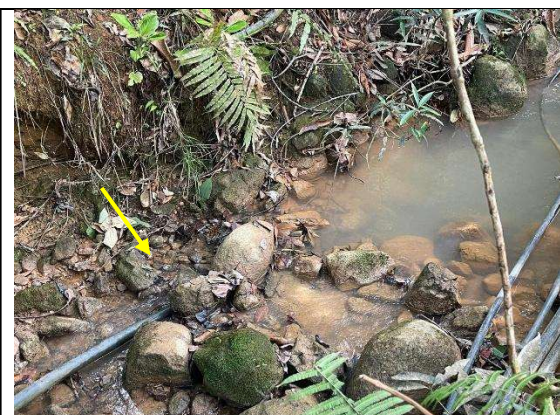
Imagen 9. Captación superficial ubicado en las coordenadas 6°02'53.38" N 74°59'35.02" W. Fuente: Cornare 2026.
