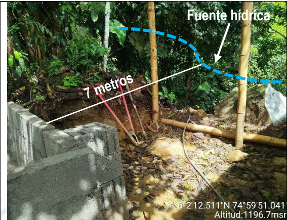
Figura 3. Construcción cercana a la quebrada La Cristalina.
