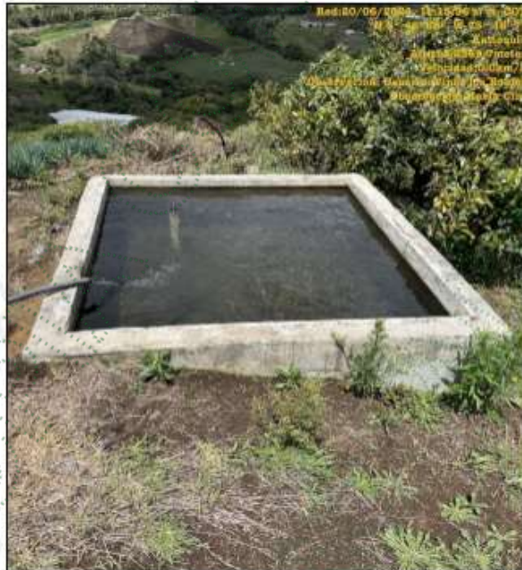
Imagen Nro.3: Tanque de almacenamiento sin dispositivo de control de flujo.
