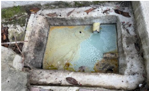
Imagen 5. Sistema de trampa grasas #2 Hotel El Trocadero, vereda El Arenal San Rafael. Cornare 2026.
