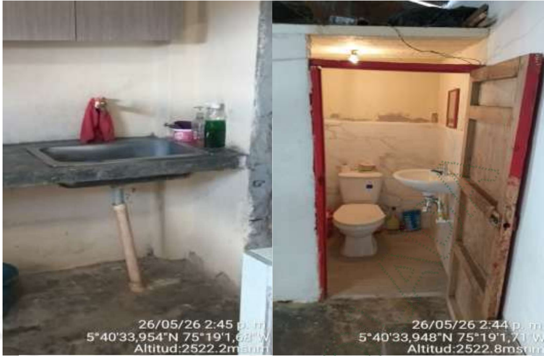
Lavaplatos y Unidad Sanitaria Caseta Comunal
