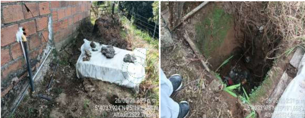
Tubería, estructura externa para ARD y Sumidero conectado a la Caseta Comunal
