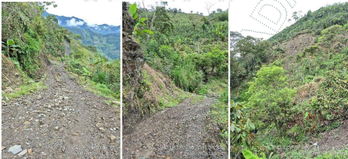
Imagen 5. Tramo de vía intervenida y material desprendido hacia la fuente.
