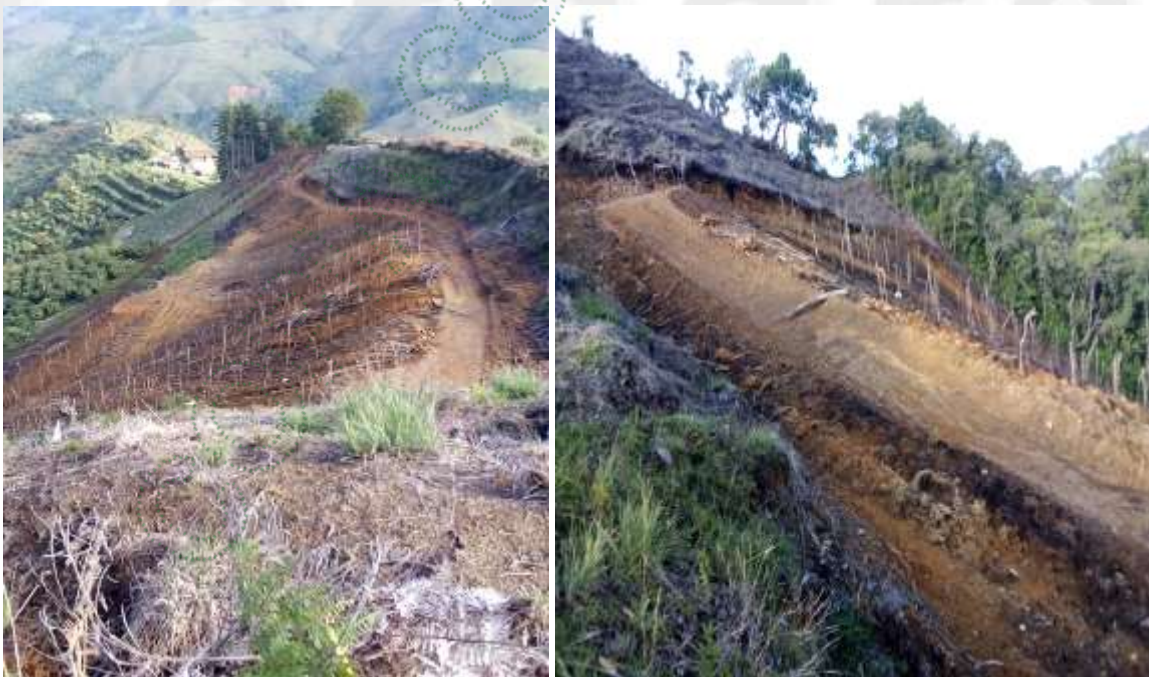
Sitio intervenido con tala, quema y movimiento de tierra.
