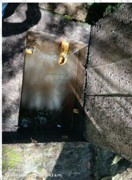
Imagen 4: Captación y tanque desarenador de los cuatro (4) usuarios
