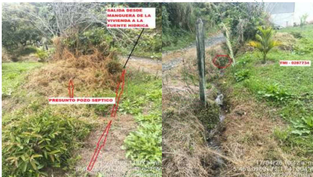
Punto donde presuntamente se encuentra el pozo séptico y salida de agua de la vivienda a la fuente
