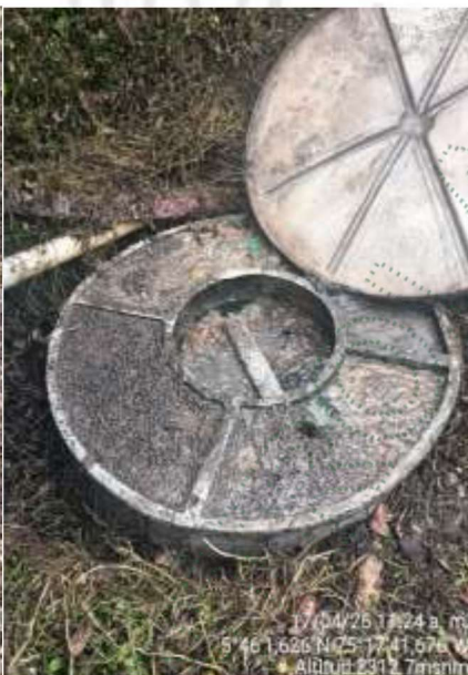
Pozo séptico destapado y colmatado
