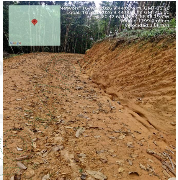
Imagen 8 presencia de cárcavas en la vía sin afirmar Cornare 2026
