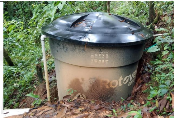
Imagen 6. Tanque desde el que se bombea el agua.
