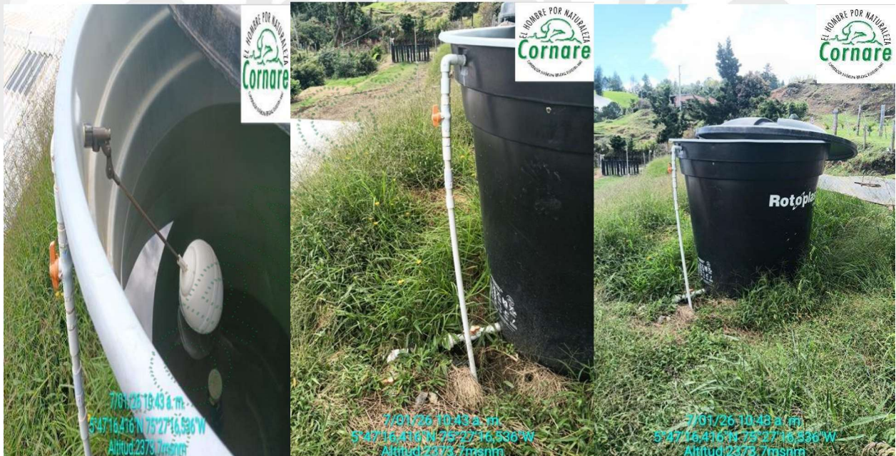
Tanque de almacenamiento predio del señor Darío del Río
