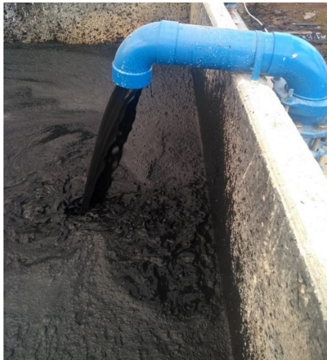
Fig 69. Ingreso de lodos a los lechos.
