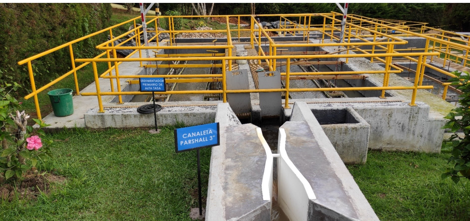
Lugar: canaleta Parshall de la PTAR Granada (2020).
