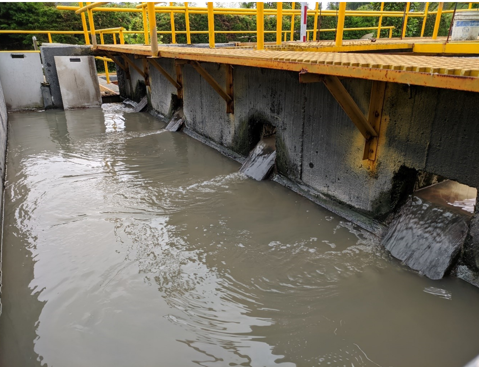
Lugar: Canal de rebose del sedimentador primario de la PTAR Granada (2021).
