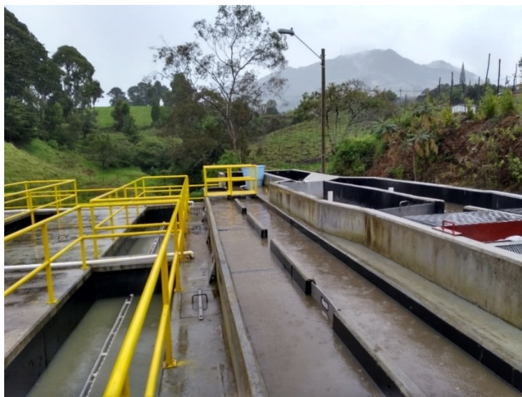
Fig 3. Ingreso de caudal con lluvias a una PTAR.
