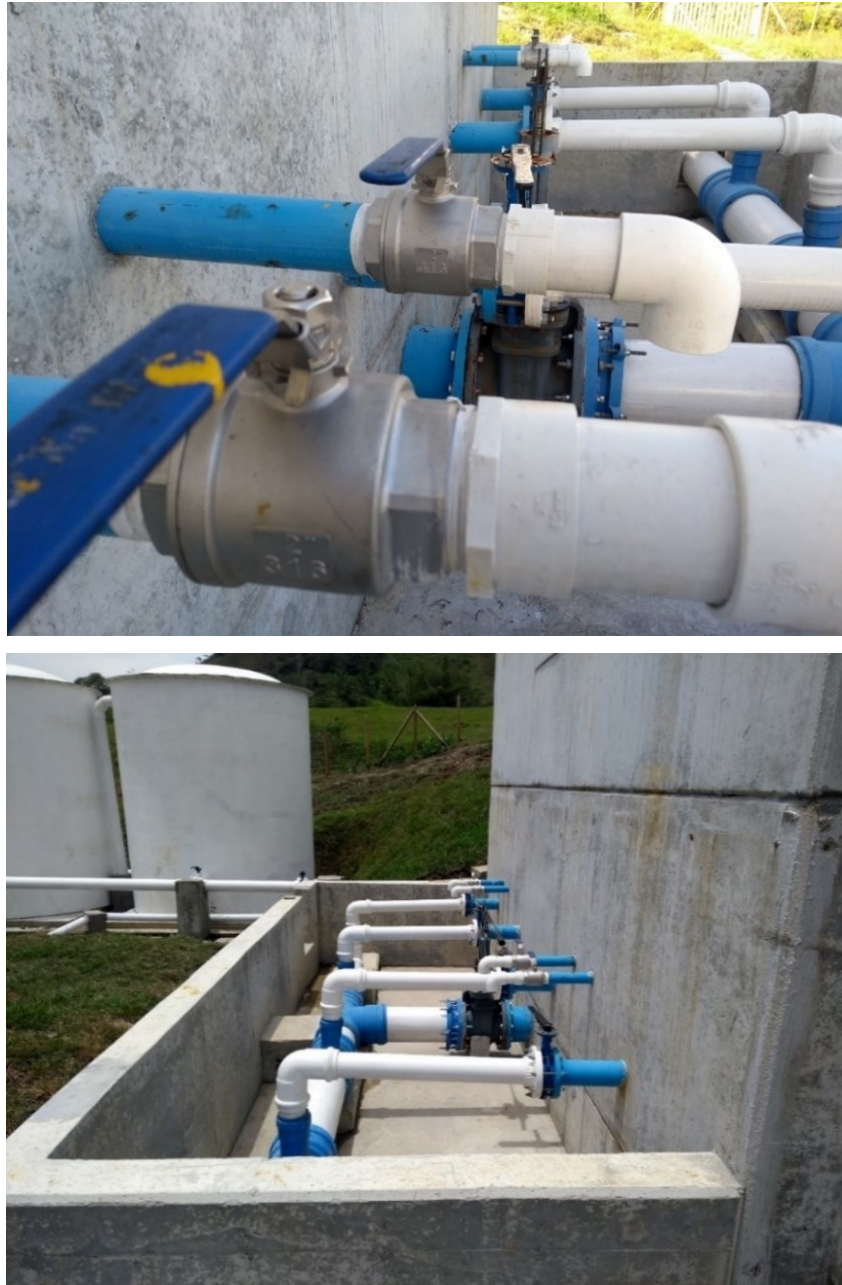
Fig 44. Válvulas de acero inoxidable.
