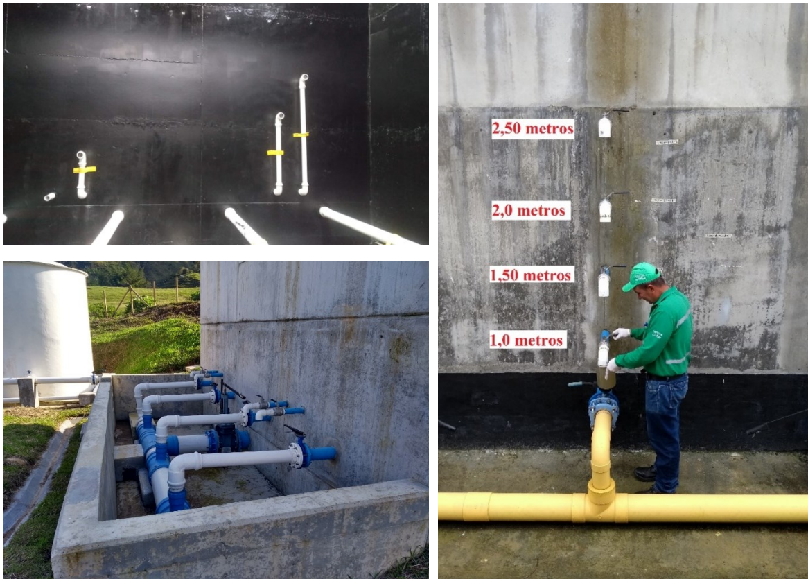
Fig 41. Válvulas de muestreo del reactor UASB.
