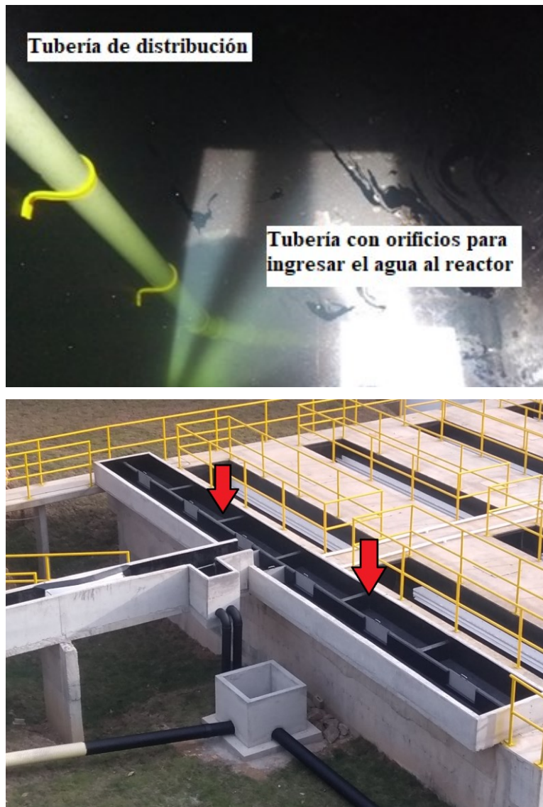
Fig 46. Tubería que ingresa el agua.
