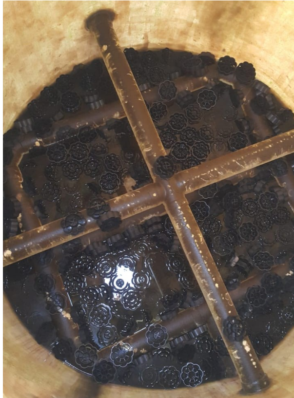
Fig 64. Tubería de lodos (fondo) rosetas y tubería para ingresar el agua.
