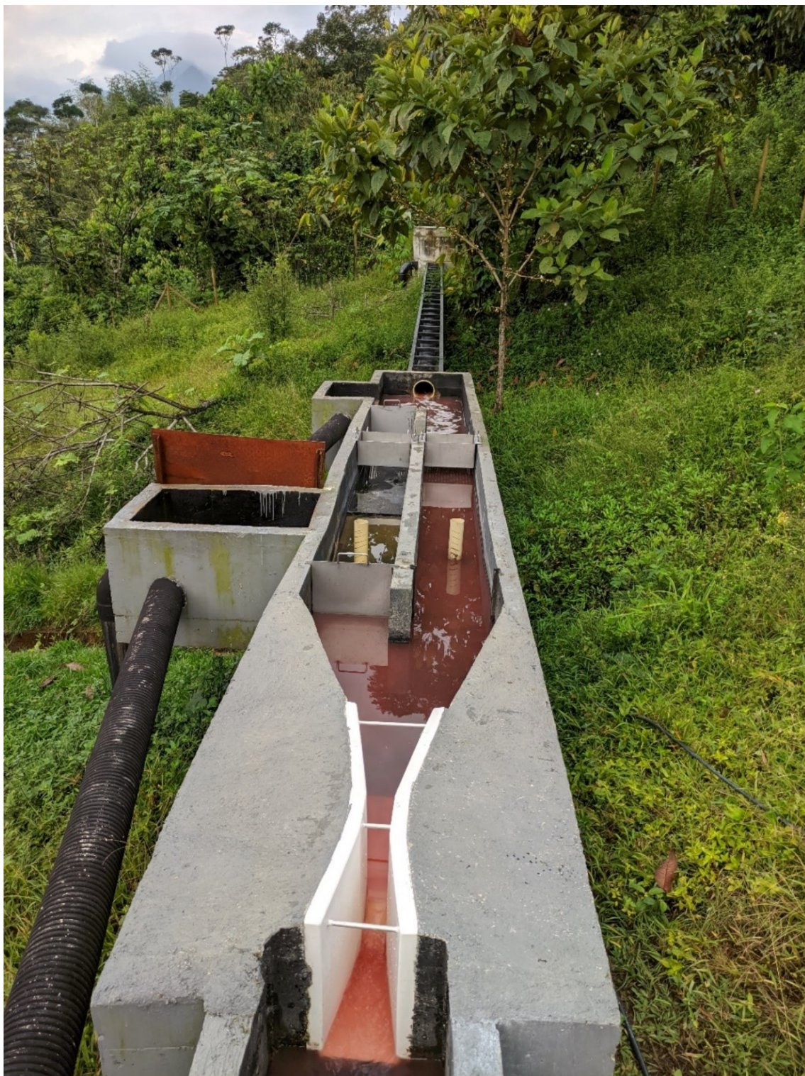
Lugar: canaleta Parshall de la PTAR San Francisco (2021).
