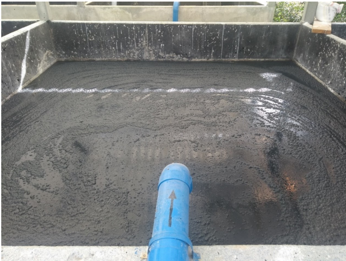
Fig 79. Lecho con lodos de un reactor UASB.
