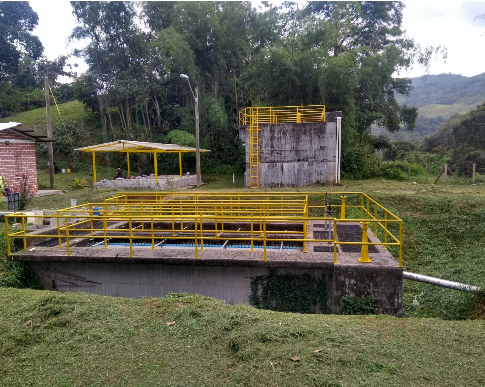
Lugar: sedimentador primario, reactor anaerobio de lodos y lechos de arena de la PTAR San Carlos (2019).
