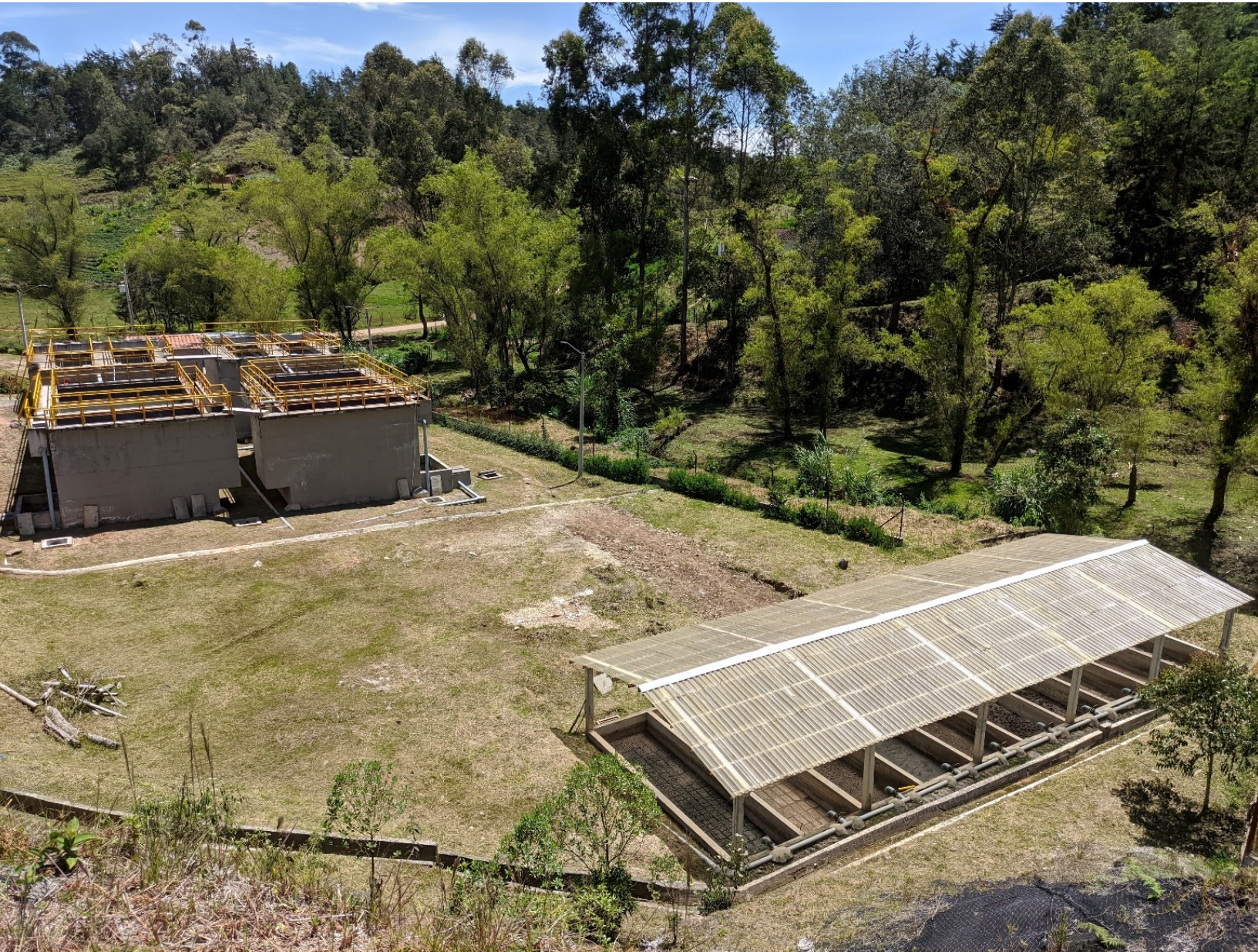
Lugar: lechos de arena de la PTAR San Vicente Ferrer (2021).
