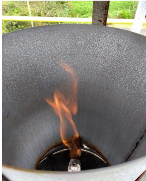
Fig 47. Quemador de biogás.
