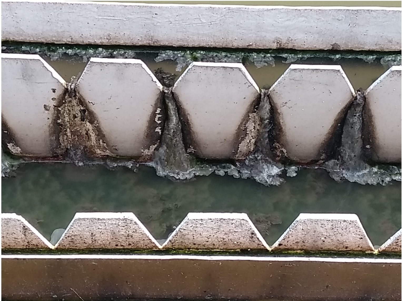
Lugar: canaleta del reactor UASB de la PTAR Sonsón (2018).
