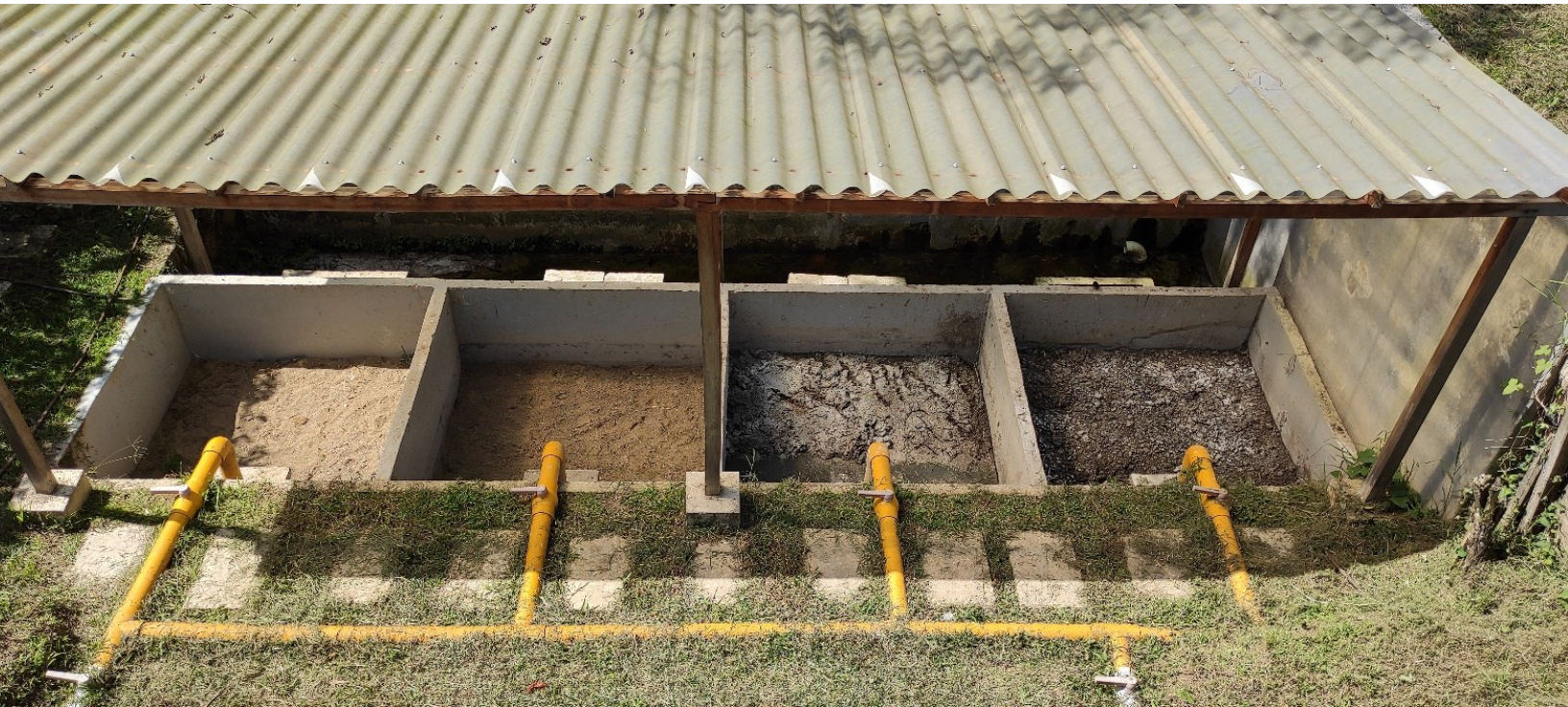
Lugar: lechos de arena de la PTAR La Piñuela en Cocorná (2021).
