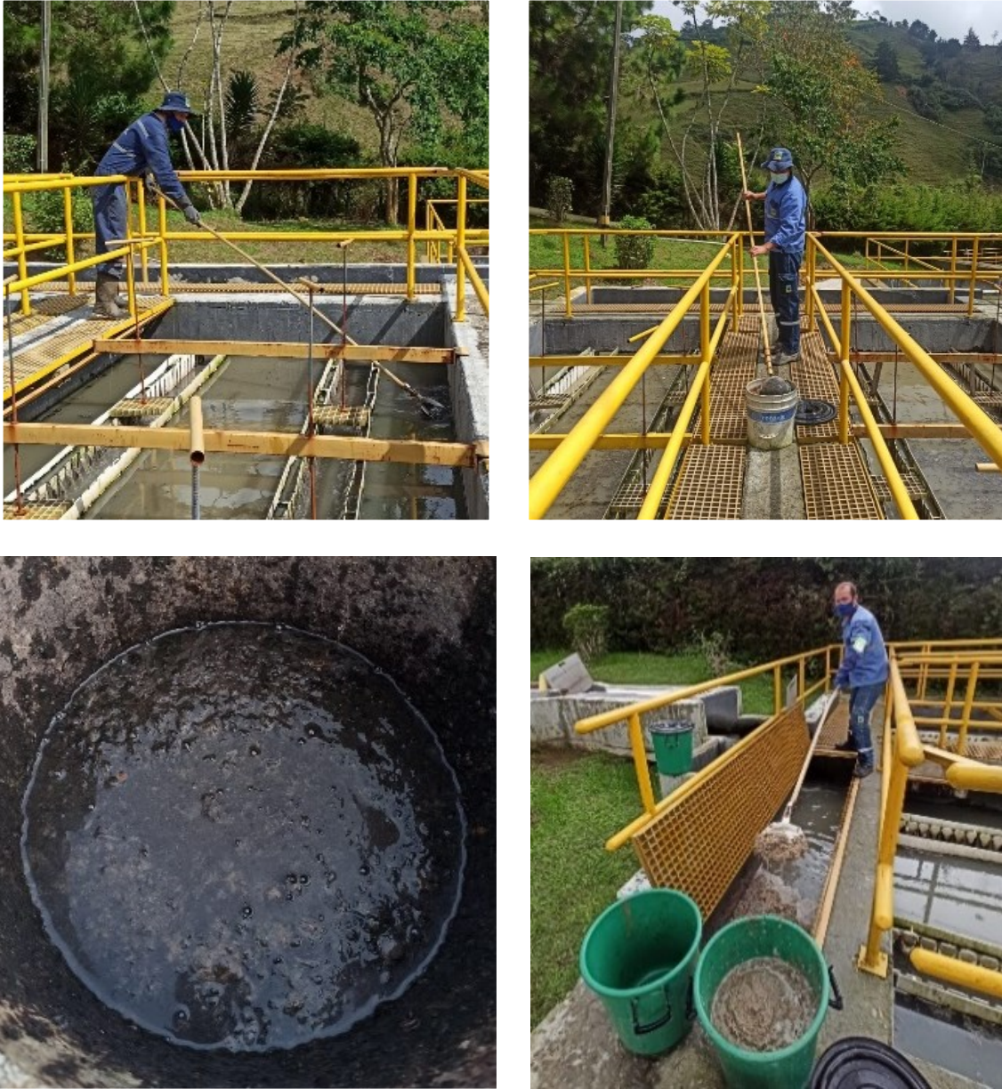
Fig 33. Sólidos flotantes extraídos del sedimentador.
