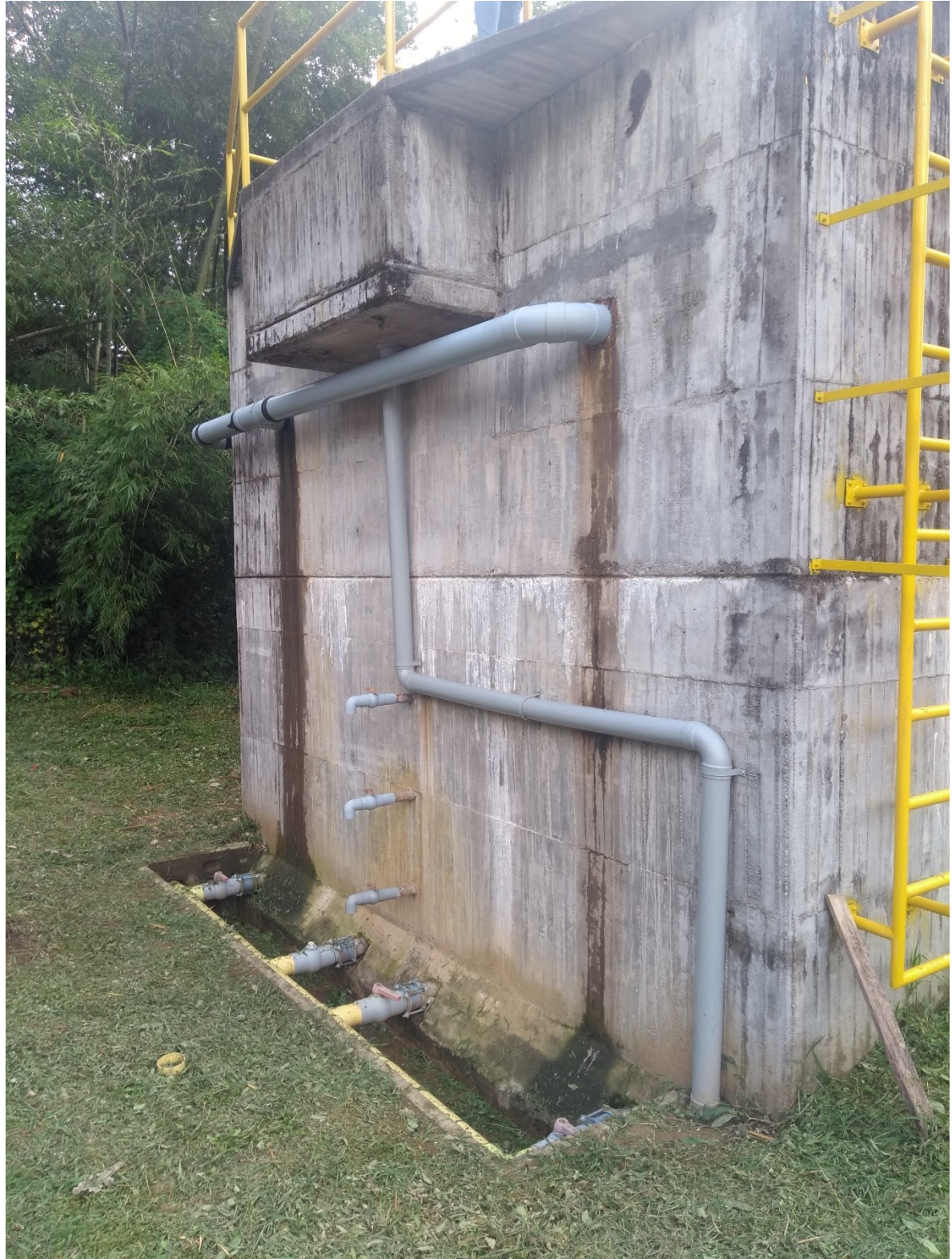
Lugar: reactor anaerobio de lodos de la PTAR San Carlos (2019).
