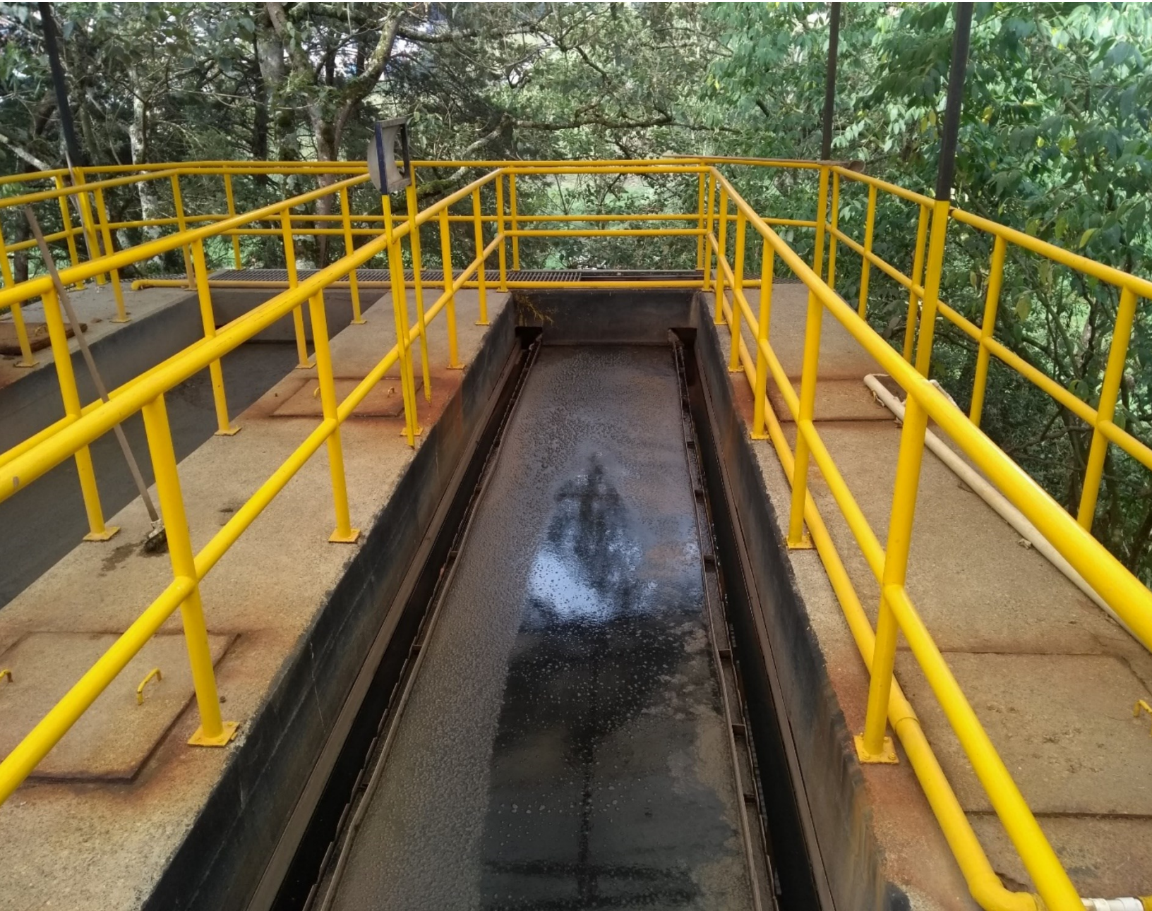
Lugar: reactor de lodos de la PTAR Marinilla (2020).
