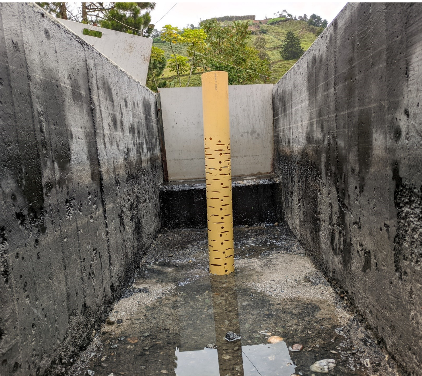
Lugar: Desarenador de la PTAR Granada (2021).
