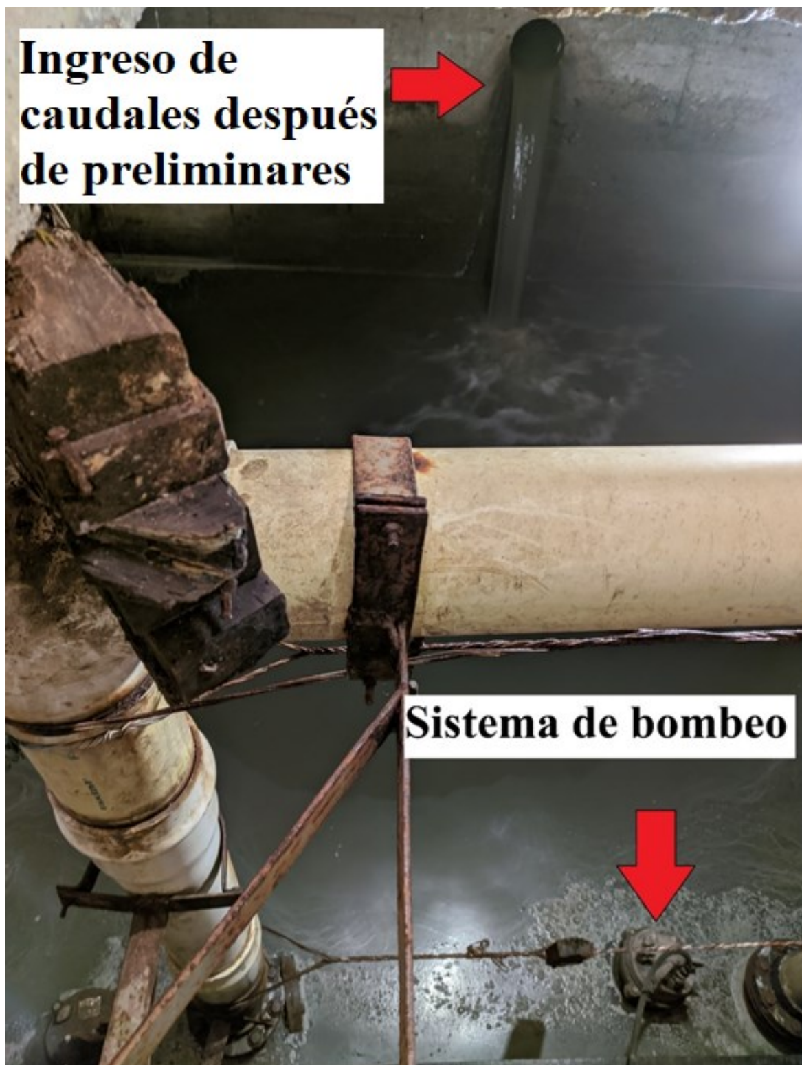
Lugar: PTAR San Vicente Ferrer. sistema de bombeo después de las rejillas, desarenador y canaleta Parshall (2020).
