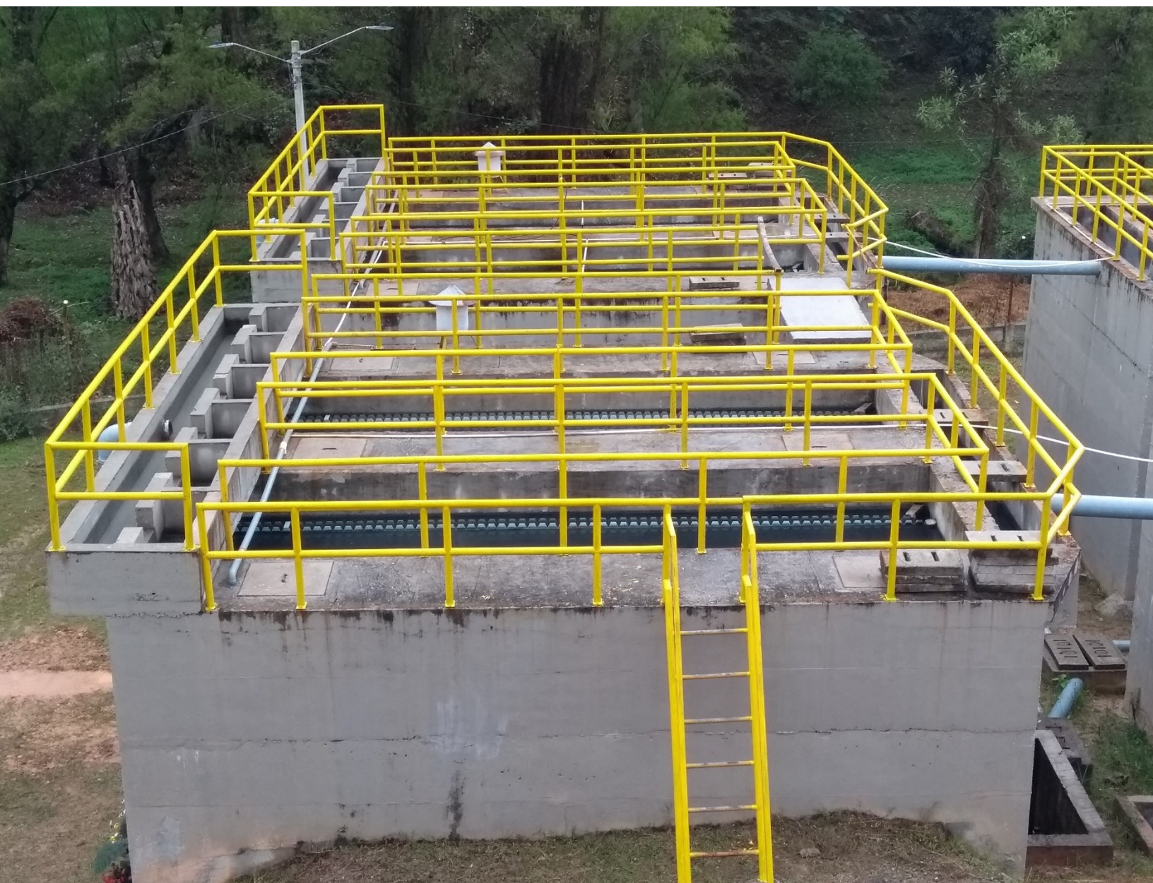
Lugar: reactores UASB de la PTAR San Vicente Ferrer (2020).
