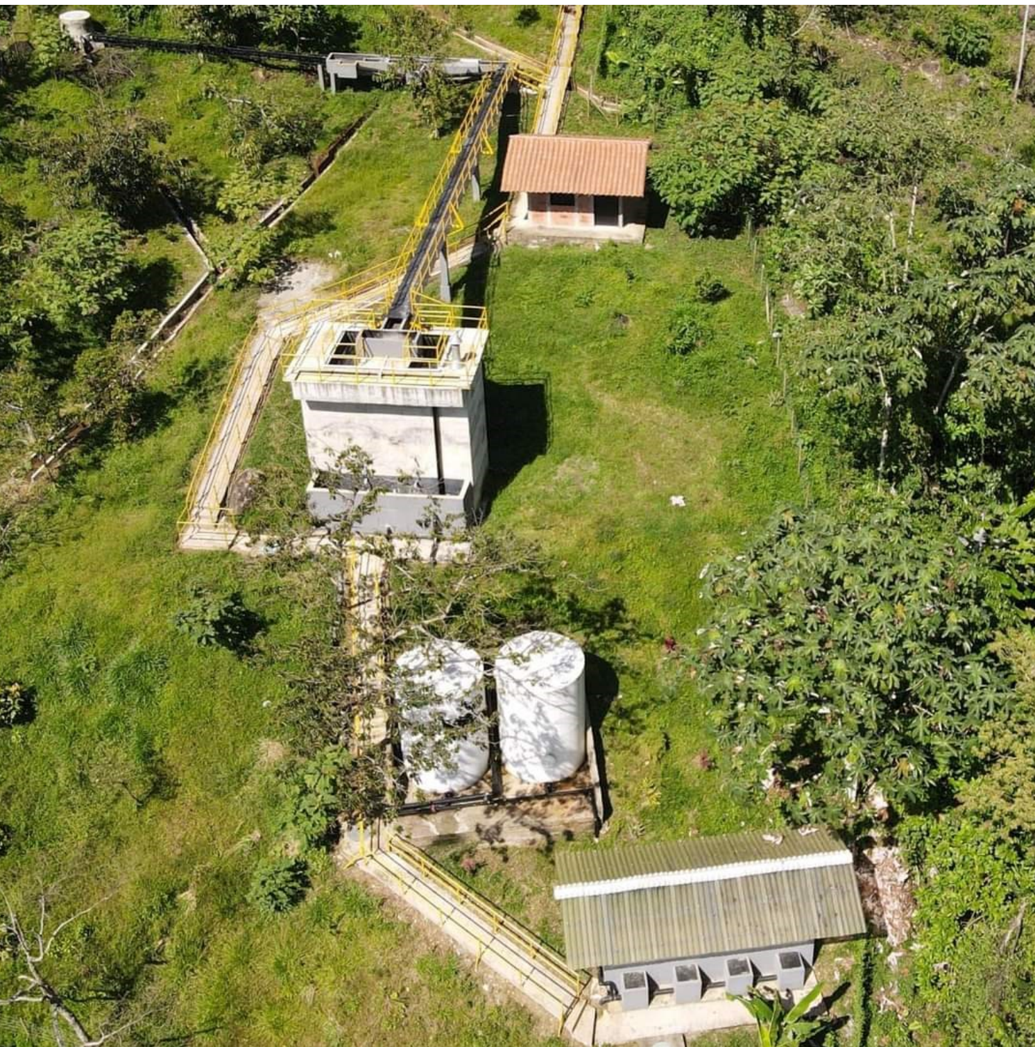
Lugar: PTAR del municipio de San Francisco (2021). © Foto: Cortesía de la empresa de servicios públicos de San Francisco.
