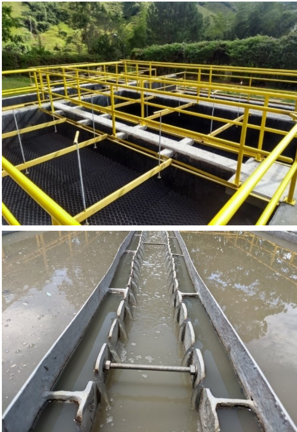
Fig 31. Sedimentador primario y canaletas.
