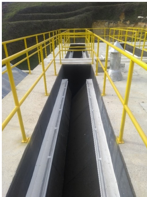
Fig 50. Sedimentador del reactor UASB.
