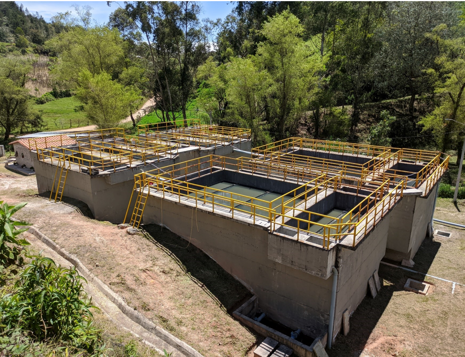
Lugar: reactores UASB, reactores PBR y sedimentadores secundarios de la PTAR San Vicente Ferrer (2021).
