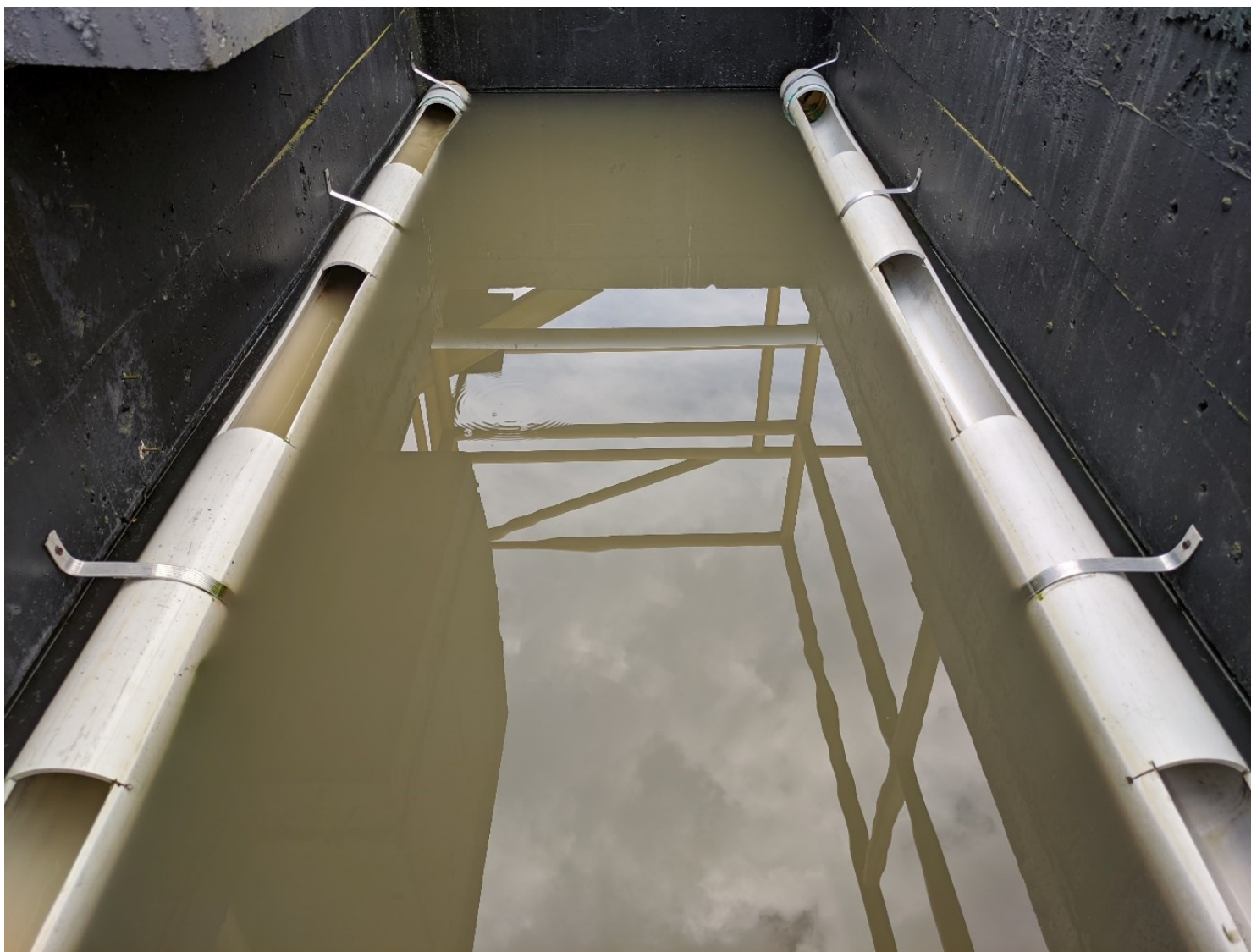
Lugar: Reactor UASB de la PTAR San Francisco (2021). Las canaletas del reactor UASB no son apropiadas porque no tienen deflectores para prevenir la salida de sólidos flotantes.
