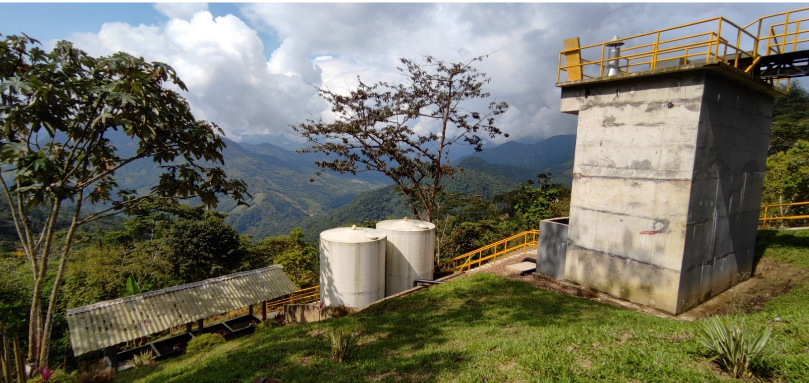
Lugar: Reactores PBR en fibra de vidrio y reactor UASB en concreto en la PTAR San Francisco (2021).
