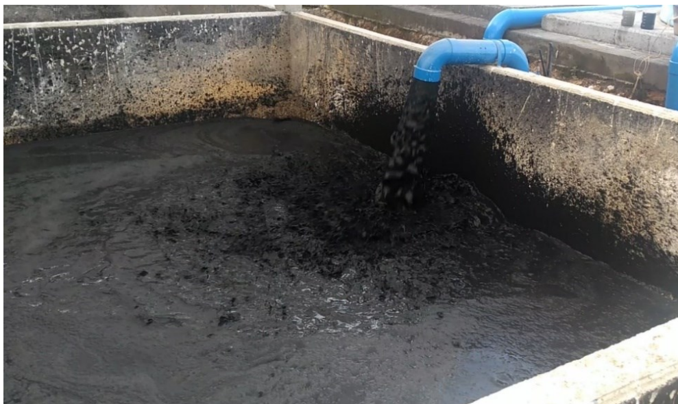
Fig 55. Ingreso de lodos a los lechos.
