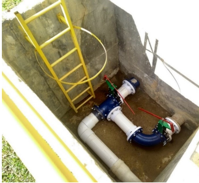
Fig 68. Válvulas del reactor PBR.
