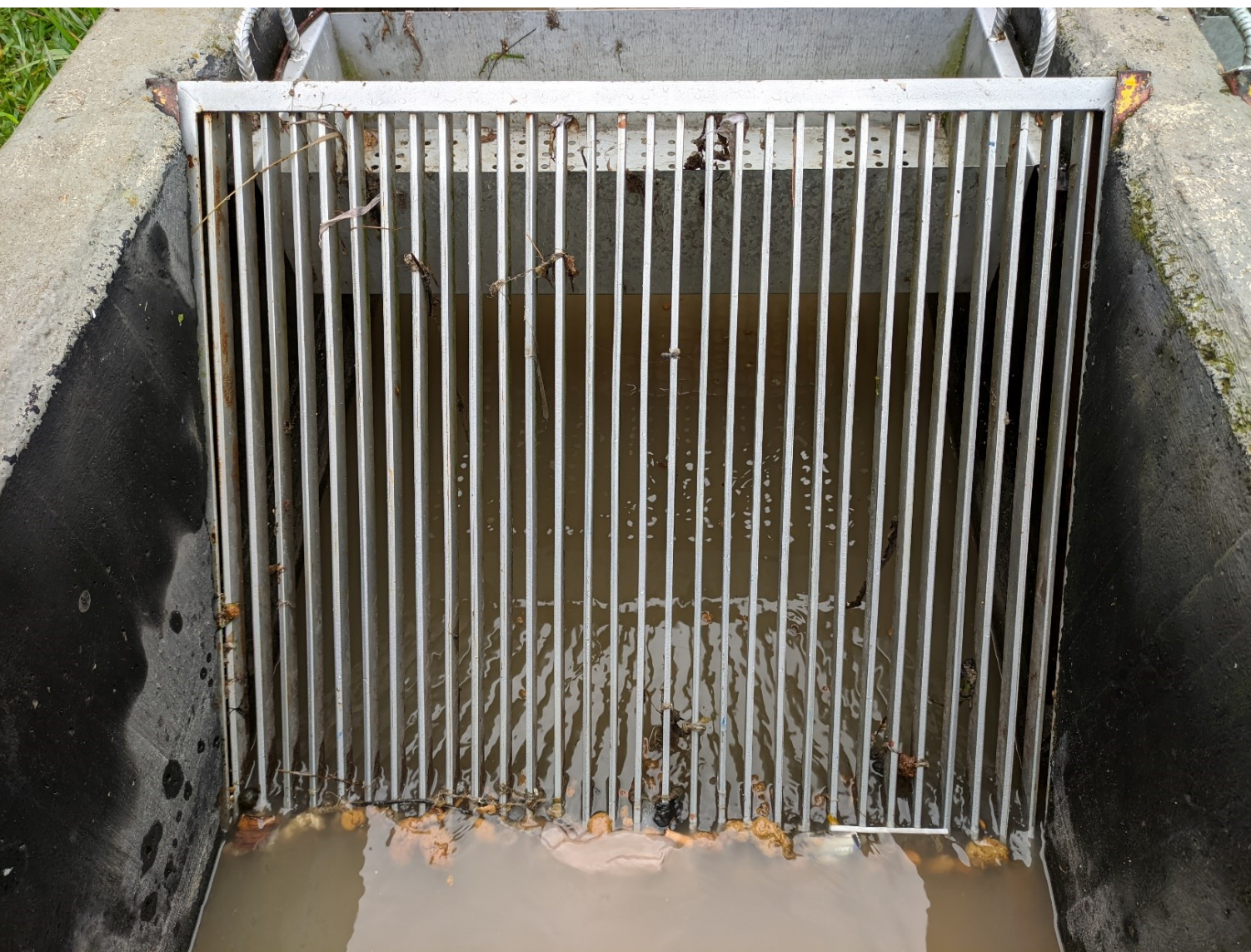
Lugar: reja de la PTAR Granada (2021).
