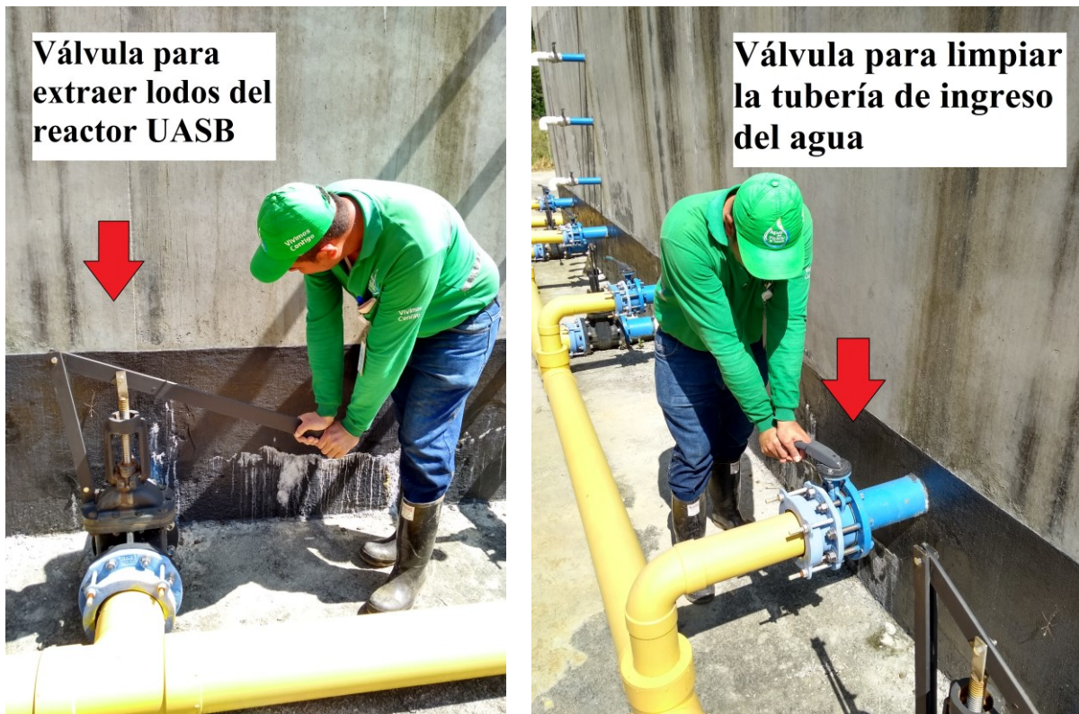
Fig 54. Válvulas del reactor UASB.
