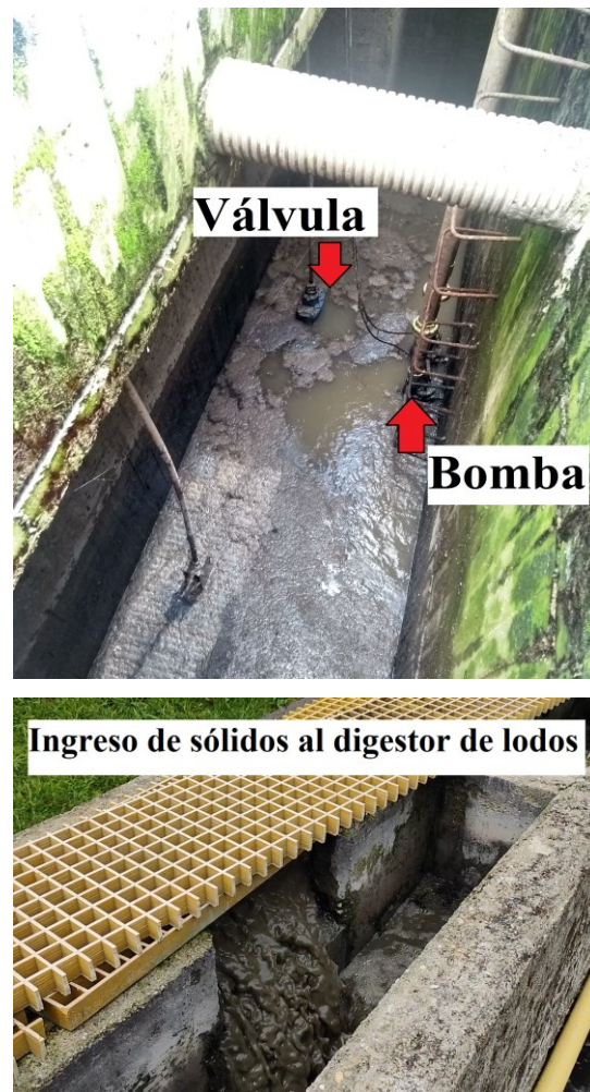
Fig 35. Sistema de bombeo e ingreso de sólidos al reactor de lodos.
