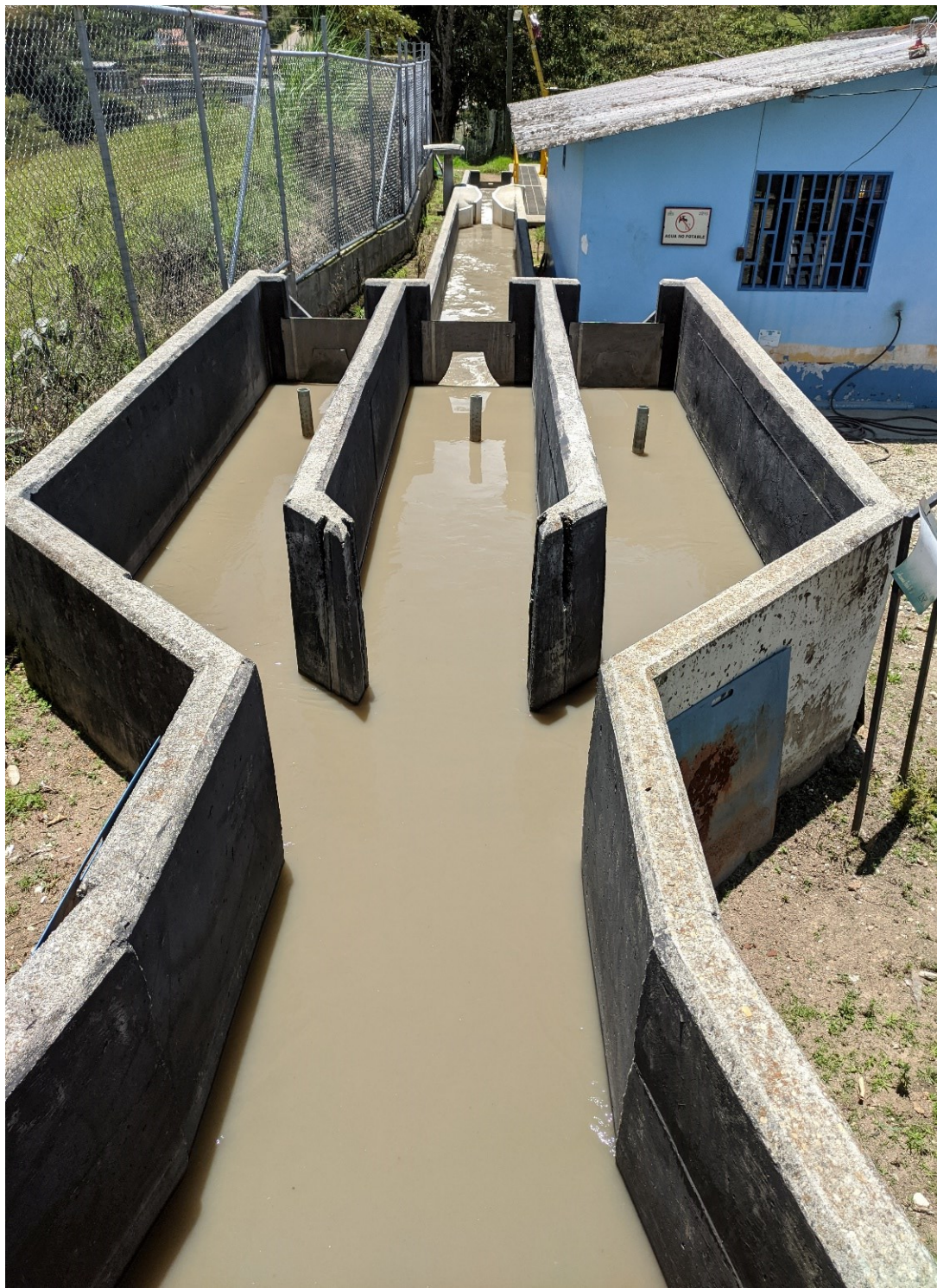
Lugar: desarenadores y vertederos sutro en la PTAR Marinilla (2020).
