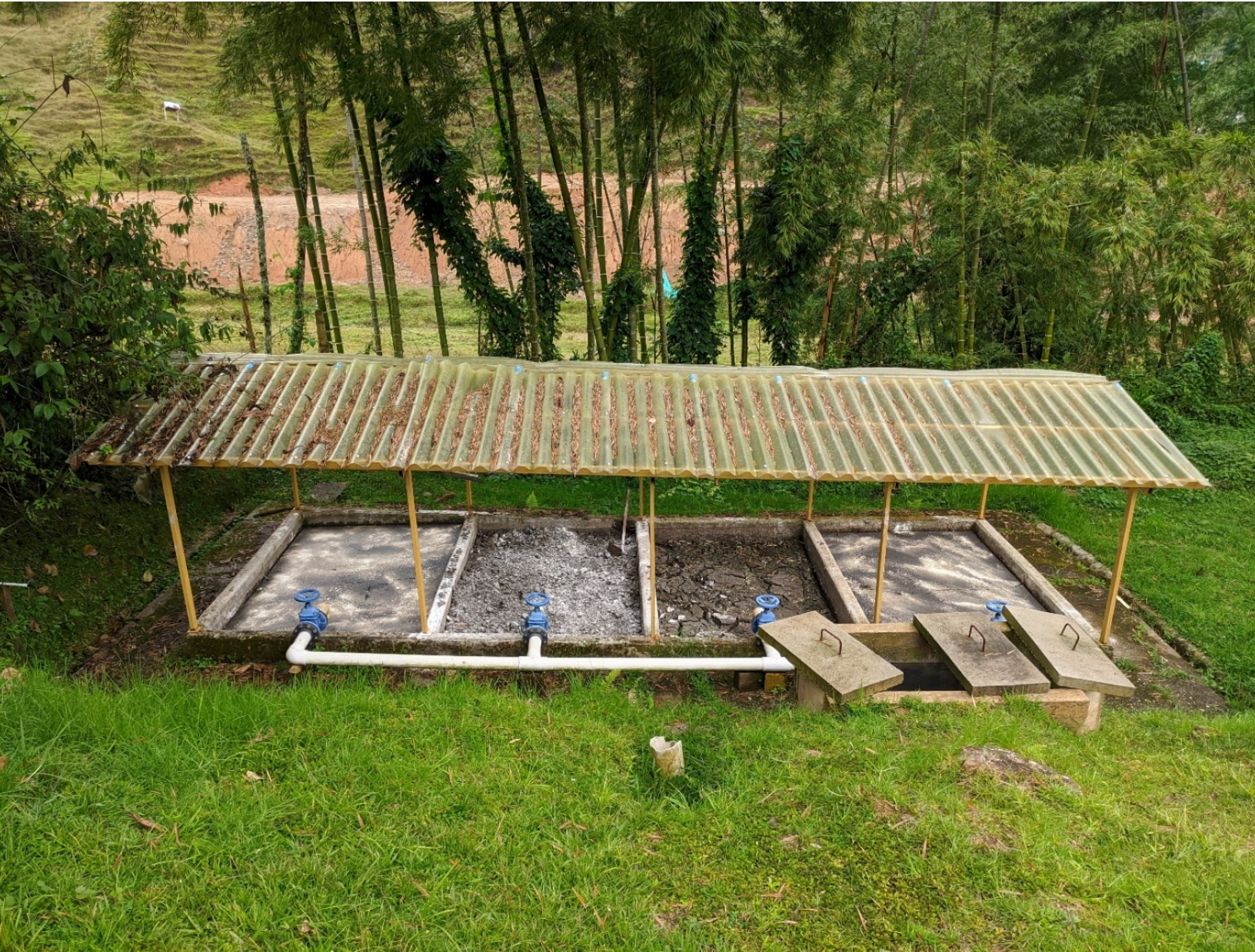
Lugar: lechos de arena de la PTAR Granada (2021).
