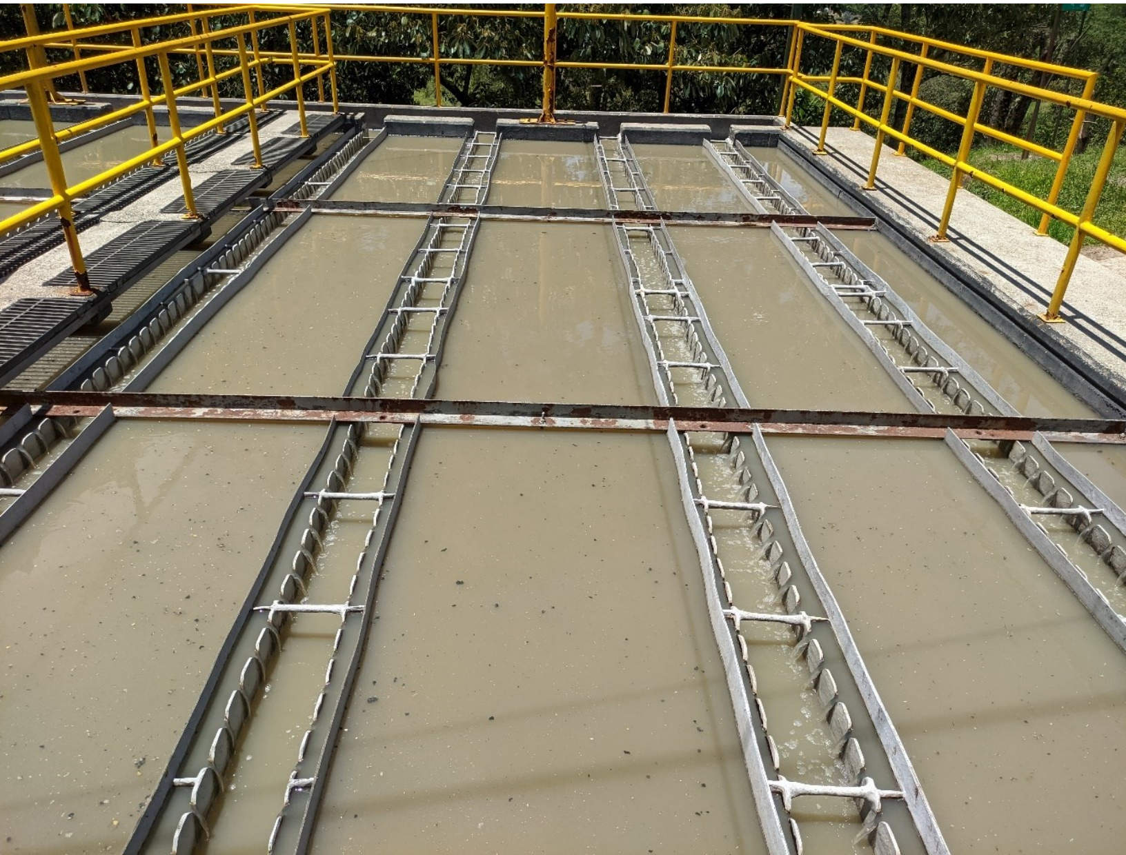
Lugar: sedimentador primario de la PTAR Marinilla (2020).
