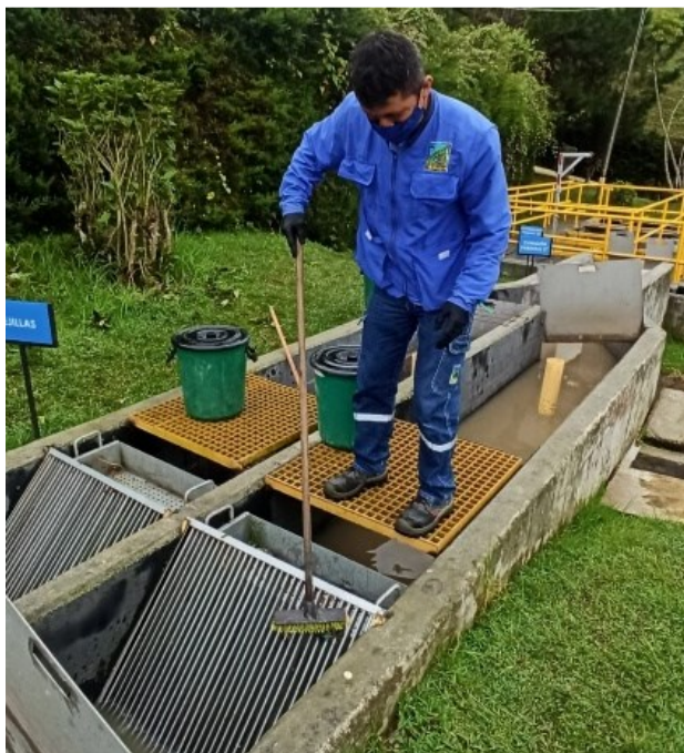
Fig 7. Reja de limpieza manual.
