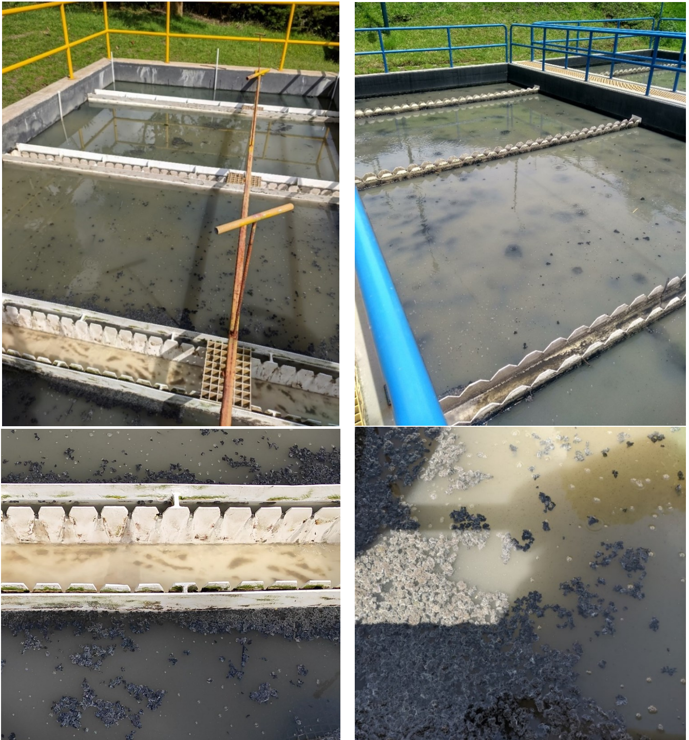
Fig 67. Sólidos flotantes extraídos del reactor PBR.
