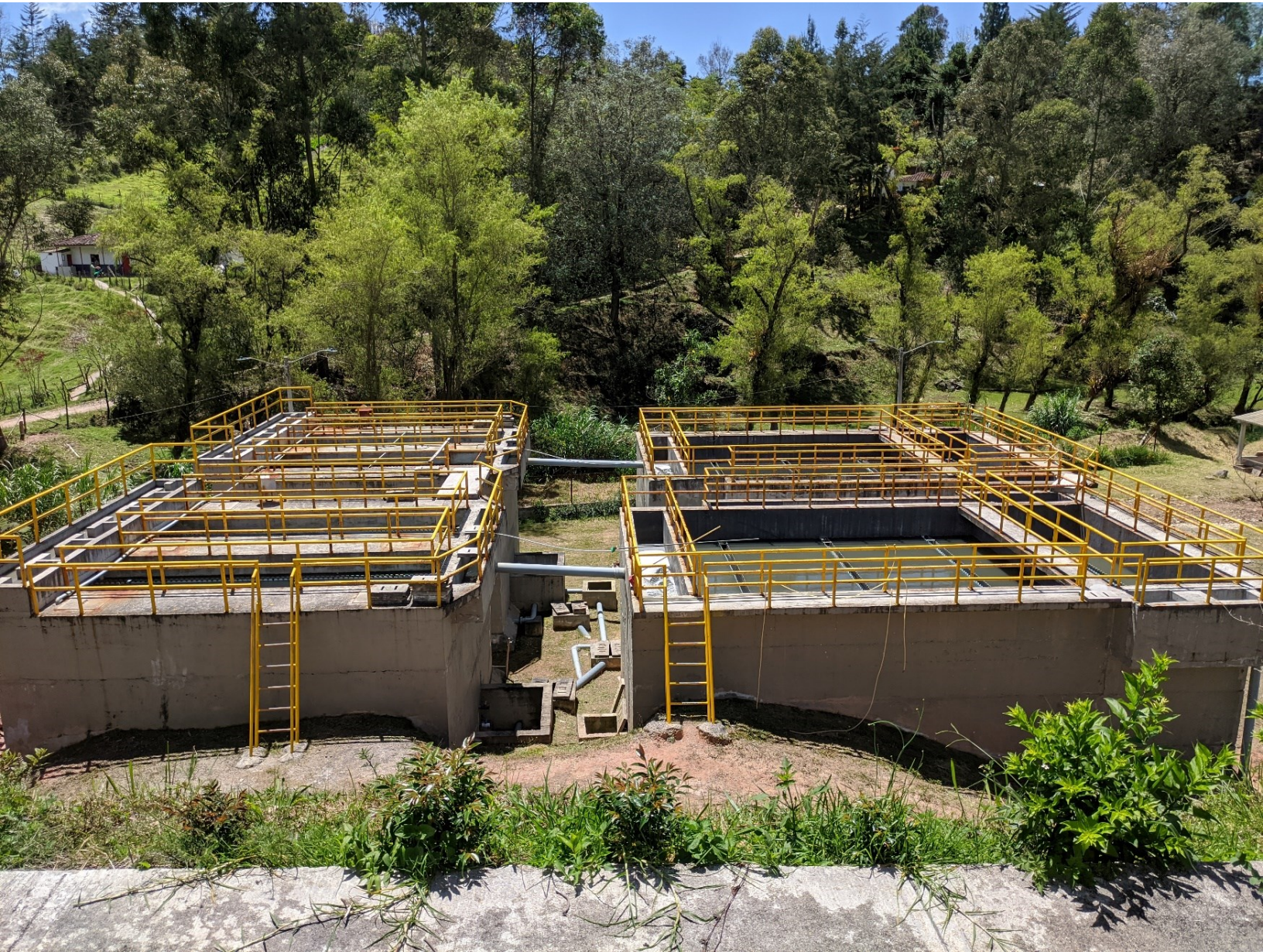
Lugar: reactores UASB, reactores PBR y sedimentadores secundarios de la PTAR San Vicente Ferrer (2021).
