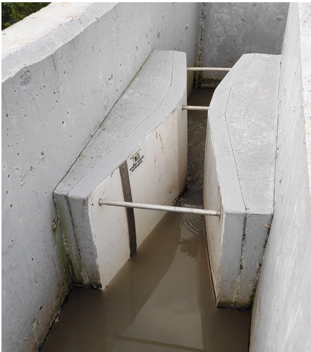
Lugar: canaleta Parshall de la PTAR La Piñuela en Cocorná (2021).
