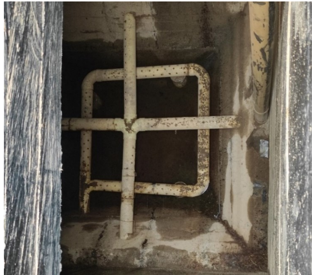
Fig 43. Tubería para ingresar el agua.
