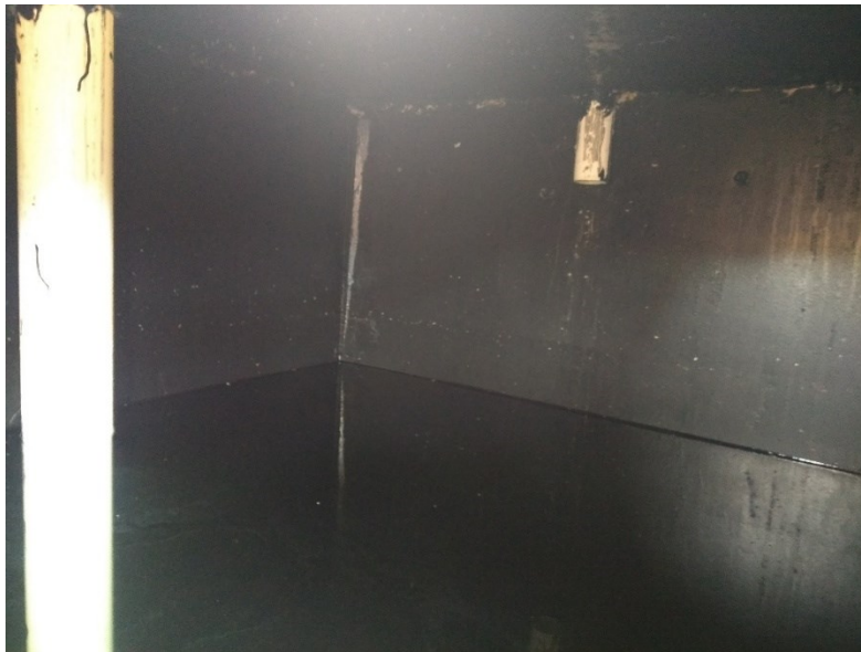
Fig 48. Cámara para biogás.
