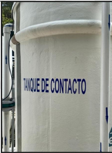
Tanque de contacto de cloro
