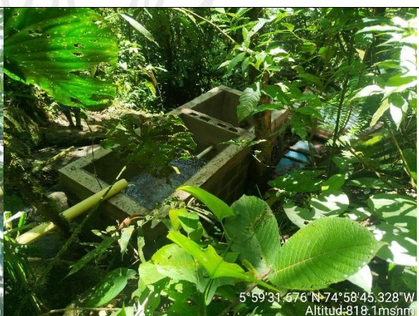
Figura 7. Tanque desarenador de las aguas de la Q. Arroyo Seco.
