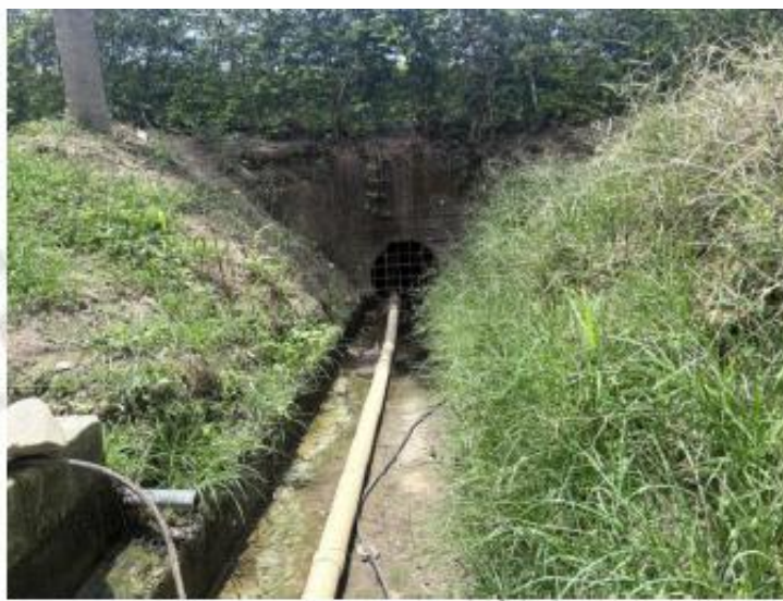
Imagen 2. Conducción de agua residual domestica Sin previo tratamiento.
