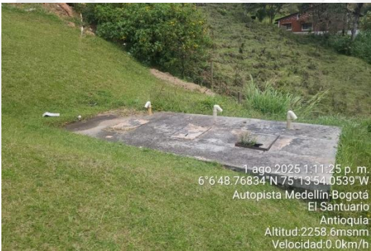
Fotografía 1. Sistema séptico integrado en mal estado
