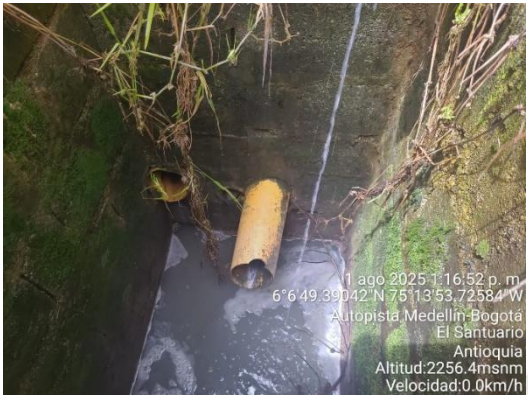
Fotografía 5. Caja en mampostería, con varias tuberías y presencia de aguas residuales.
