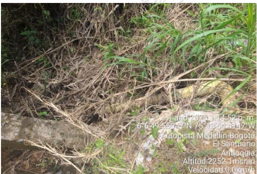
Fotografía 3. Estructura de descarga en mal estado
