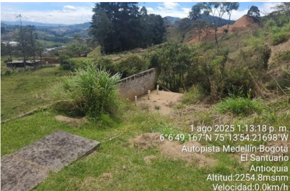
Fotografía 2. FAFA complementario en mal estado
