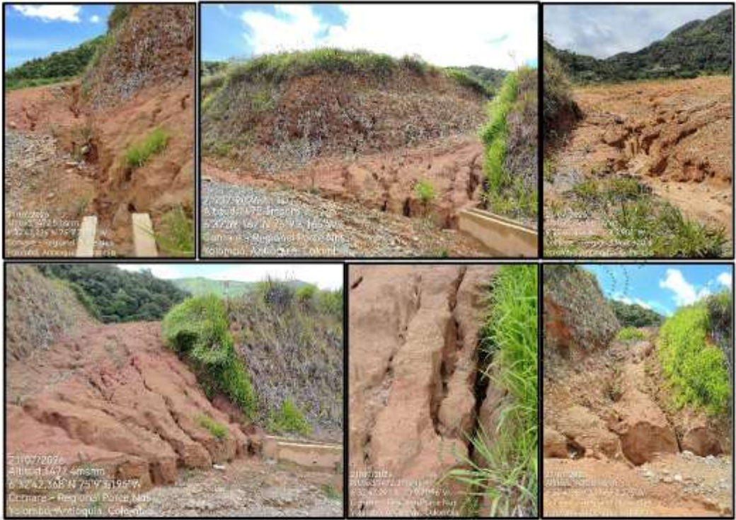
Imagen 6. Cornare. 2026. Procesos de erosión laminar por escorrentías sobre carretera interna.
