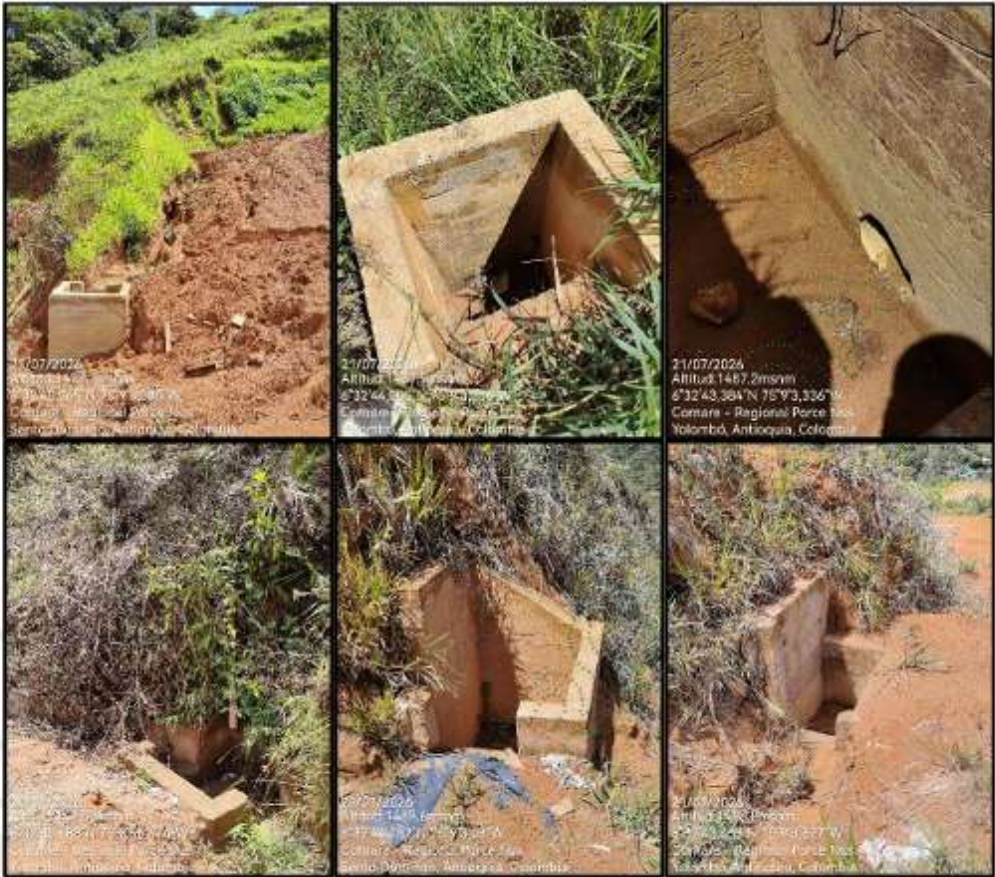
Imagen 3. Cornare. 2026. Cajas disipadoras ubicadas en diferentes puntos como complementos a las cunetas laterales.
