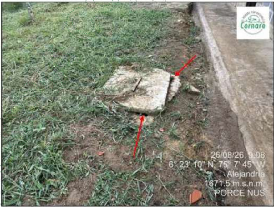
Imagen 3. Cornare. 2026. Caja de inspección.
