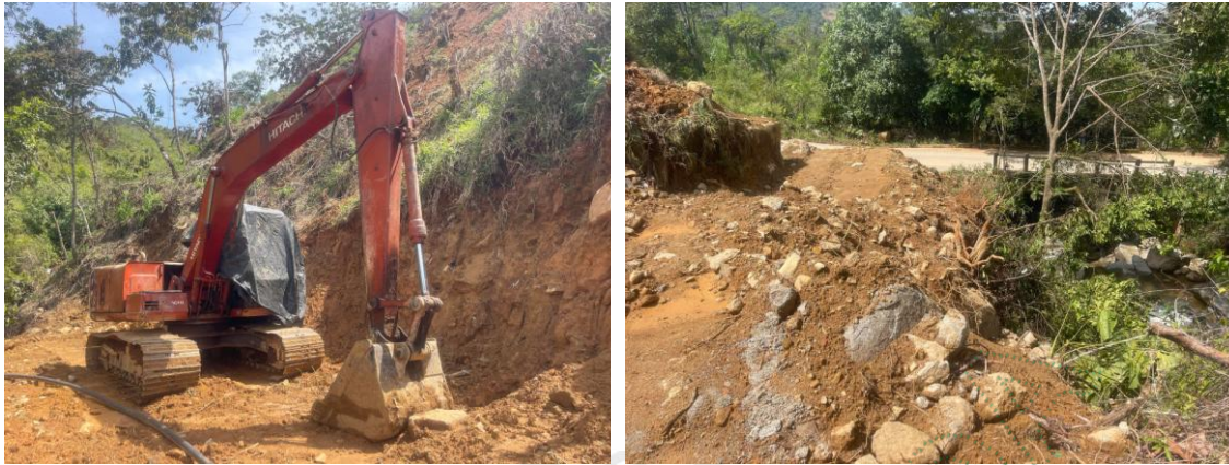
Figura 1. Evidencias fotográficas de las actividades de movimiento de tierras en el sitio con coordenada geográfica -75°0'37.26" W, 6°3'9.48" N, sobre la ronda hídrica de la Quebrada La confusa. Fuente: Cornare 2026
