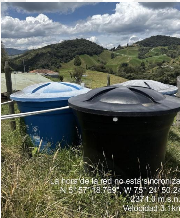
Tanque almacenamiento 1000L
