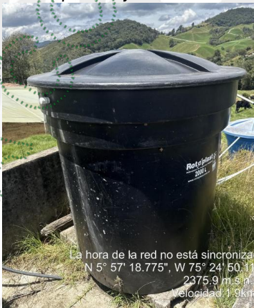
Tanque distribución 2000L
