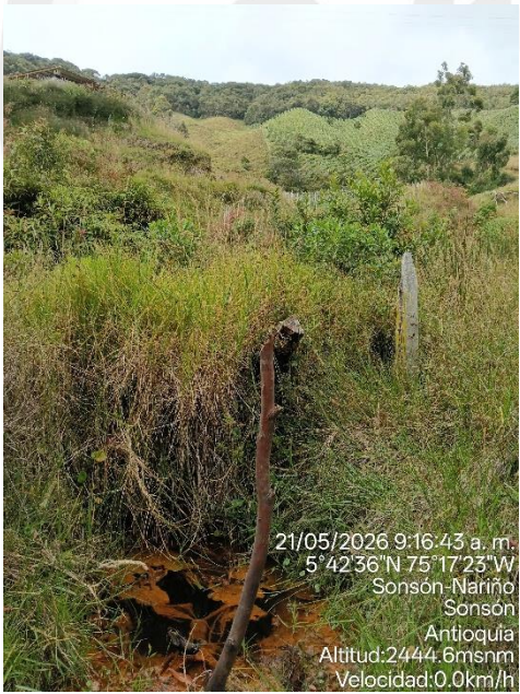
Punto de captación
