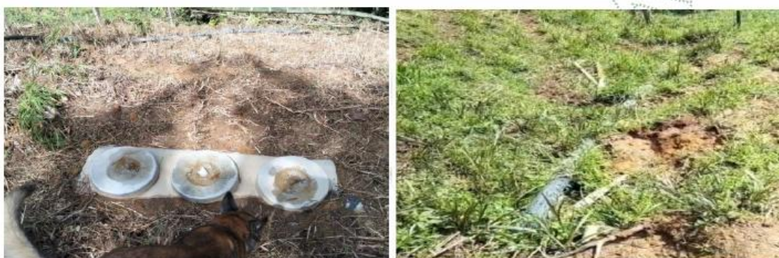
Imagen 8 y 9 pozo séptico y descarga
