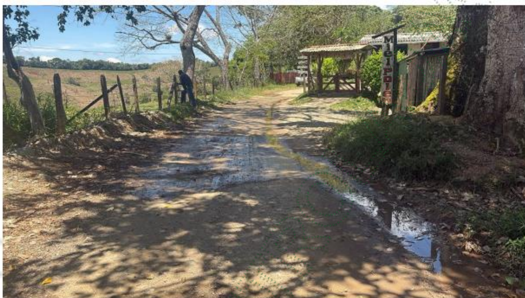
Imagen 3. Suelo húmedo y pequeños encharcamientos sobre la vía
