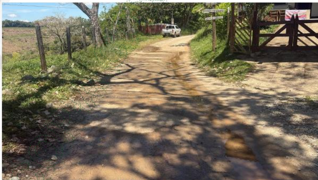
Imagen 4. Suelo húmedo y pequeños encharcamientos sobre la vía
