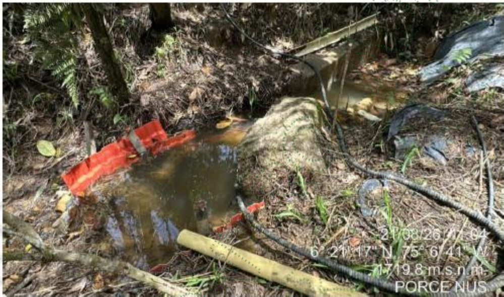
Figura 5. Infraestructura para obra de captación 1.
