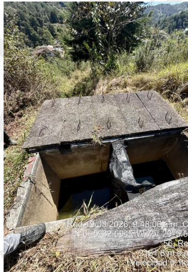
Tanque de almacenamiento
