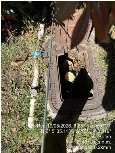
Contador acueducto y llave de paso fuente
