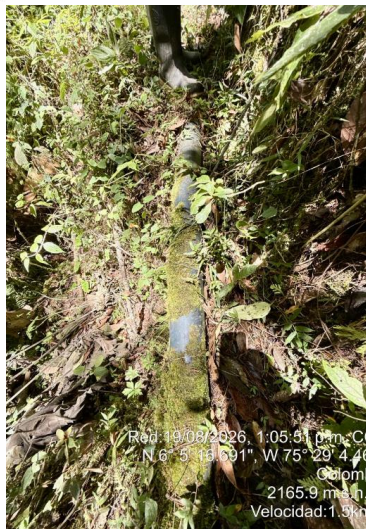
Tubería de conducción
