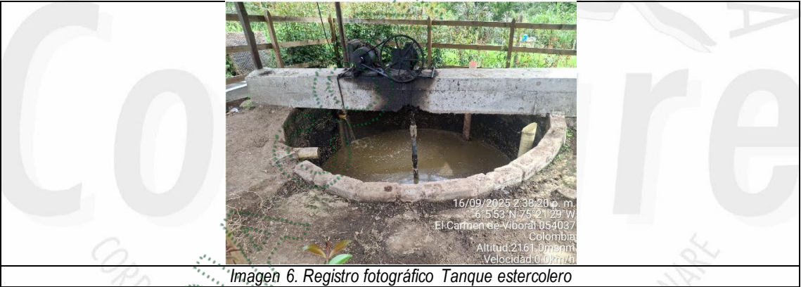
Imagen 6. Registro fotográfico Tanque estercolero
