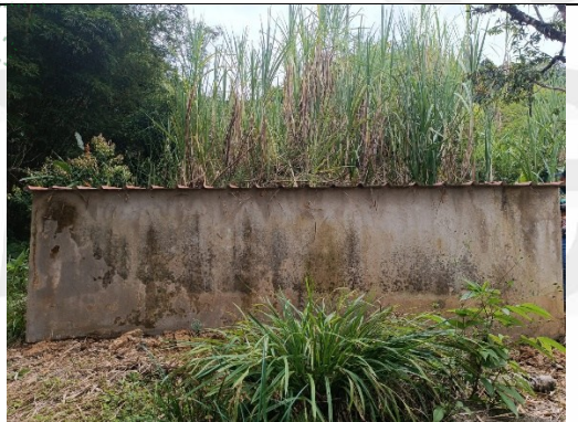
Imagen8. Tanque almacenamiento - Captación La Ramada 02. Cornare 2026
