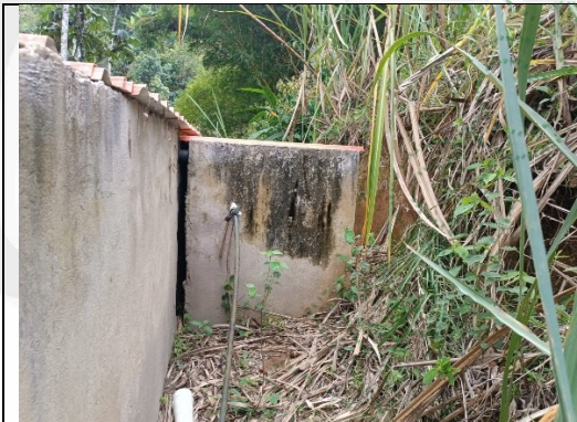
Imagen7. Tanque desarenador Captación La Ramada 02. Cornare 2026
